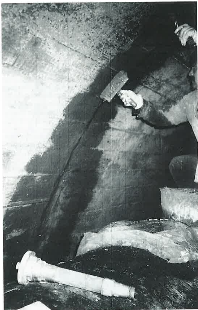
SANACE PRACOVNÍ SPÁRY V MONOLITICKÉM OSTĚNÍ ŠTOLY ZAČINA ODSTRANĚNÍM ZNEHODNOCENÉHO BETONU A UTĚSNĚNÍM RYCHLE TVRDNOUČÍ MODIFIKACÍ XYPEXU.
