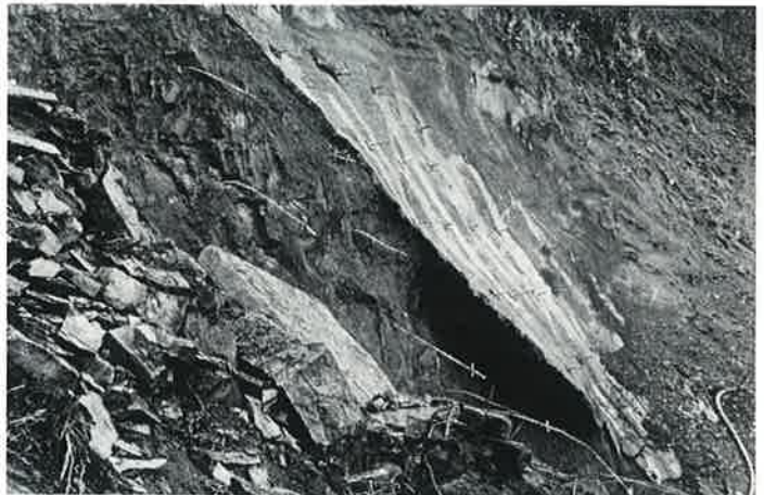
Obr. 13. Porušený kryt ze stříkaného betonu a vyvlečené kotvy provizorního zajištění portálu
