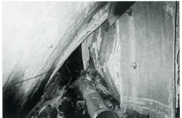
Obr. 14. Pravá štola - porušení ostění ze stříkaného betonu
