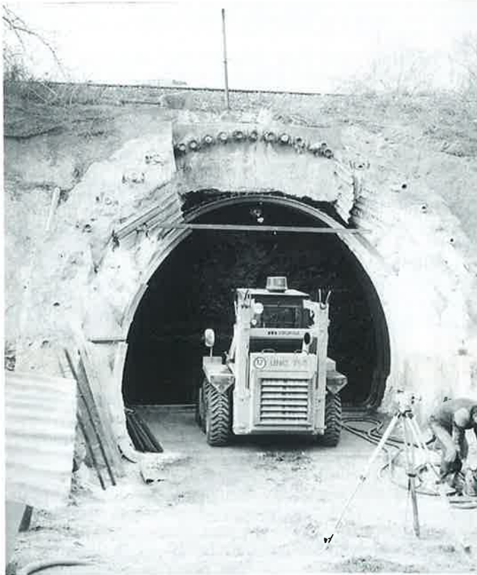
Obr. 4. Počiatočná fáza razenia podchodu pre peších pod železničnou traťou. Votknutú klenbu tvorí sústava mikropilot a preinjektovaná zemina. Na odťažbu a manipuláciu s materiálom sa s výhodou používa lopatový nakladač.
