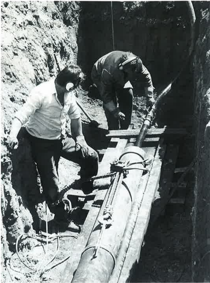
Obr. 4: Beranění chráničky z ocelových trub pod komunikací z rozšířeného výkopu (Kralupy n. Vlt.)
