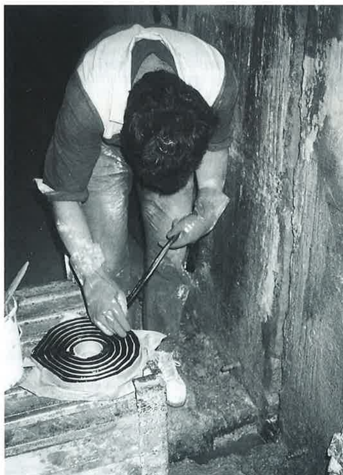
Obr. 10 Pro opravu nefunkční dilatační spáry lze použít bobtnavý bentonitový profil WATERSTOP RX.
