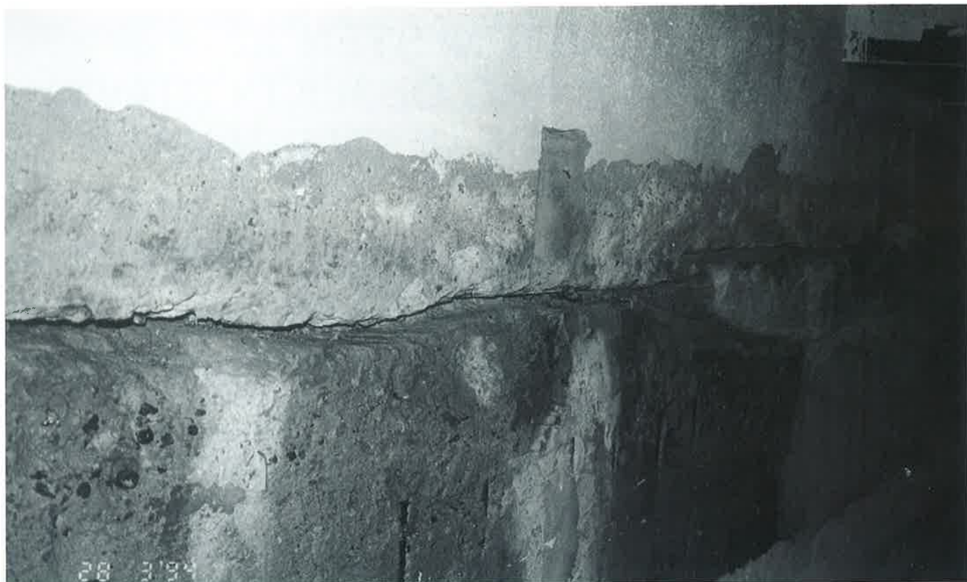
Obr. 11 Netěsná vodorovná pracovní spára ve stěně podzemního krytu po otryskávání vysokotlakým paprskem.
