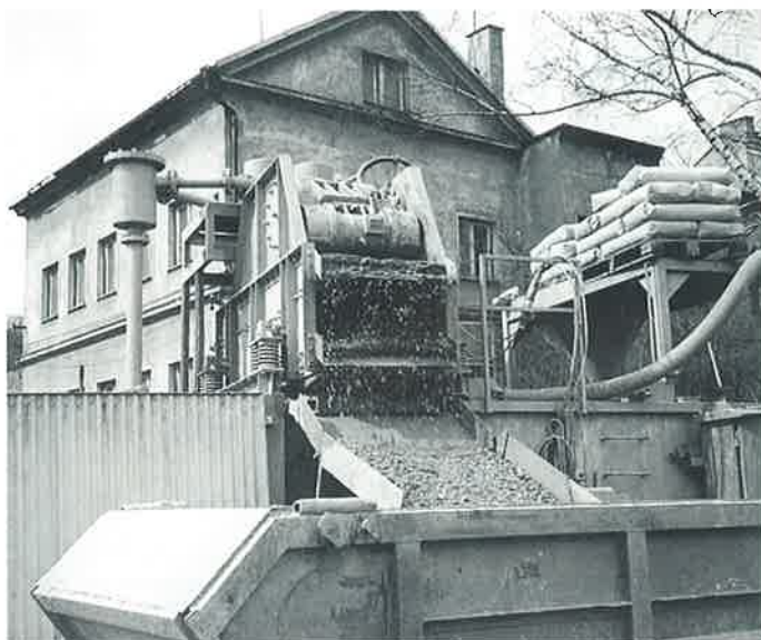
Obr. 1 Vibrosíta separačního zařízení odtěžovacího slurry systému
