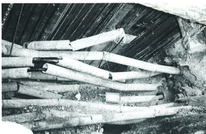
Prolomený kabelovod v původní šachtě
