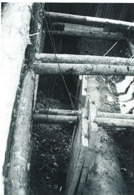
Havarovaná stoka v horní šachtě
