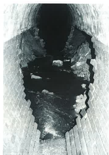
Havarovaná stoka pod spodní šachtou
