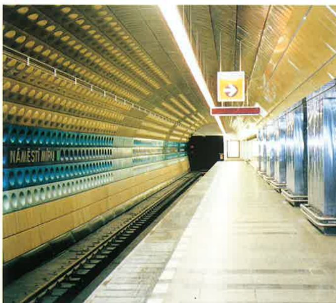
Obr. 5 Nástupišť s podélným svítidlem Platform with the line lighting fixture
