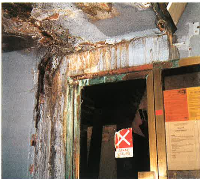
Obr. 2 Průsaky v prostupu nástupišť Leaks in the cross passage
