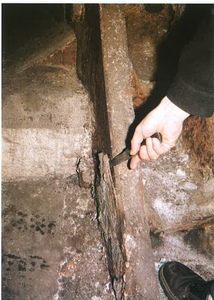
Obr. 7 Průsaky v tunelovém ostění Leaking joints of the tunnel lining
