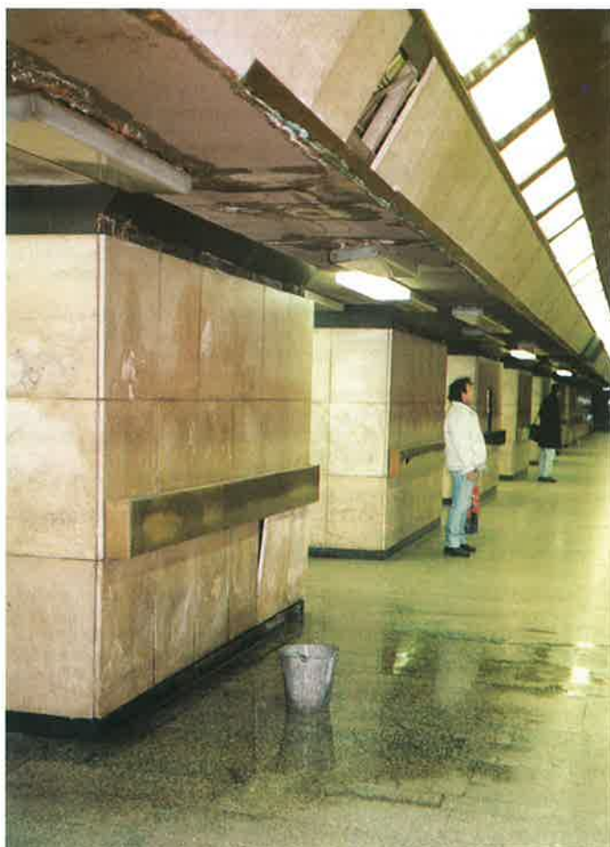
Obr. 6 Průsaky v obkladech stanice Leaks in the station facings
