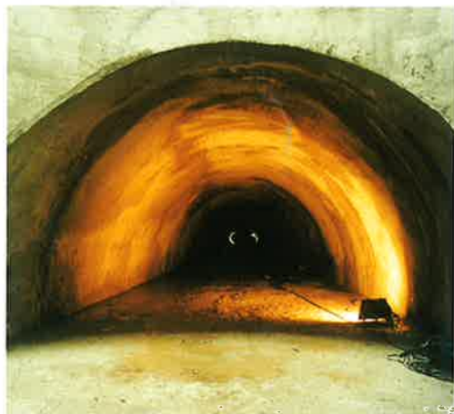
Štolovaný podchod pod tratí ČD v Praze - Radotíně Driven cross passage under the railway track of ČD, Prague - Radotín
