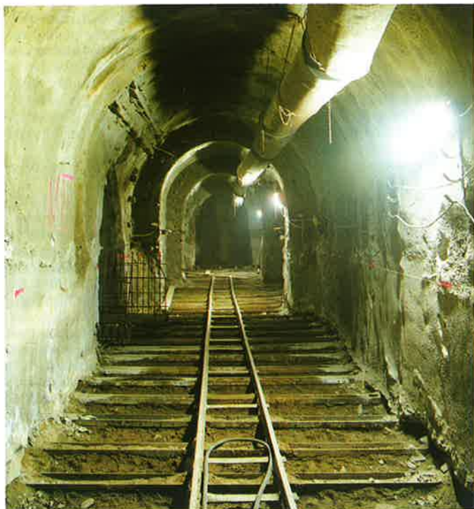
Obr. 6 Primární ostění kolektoru. Připraveno pro uložení armatury. Primary lining of the utility tunnel. Ready for fixing rebars.
