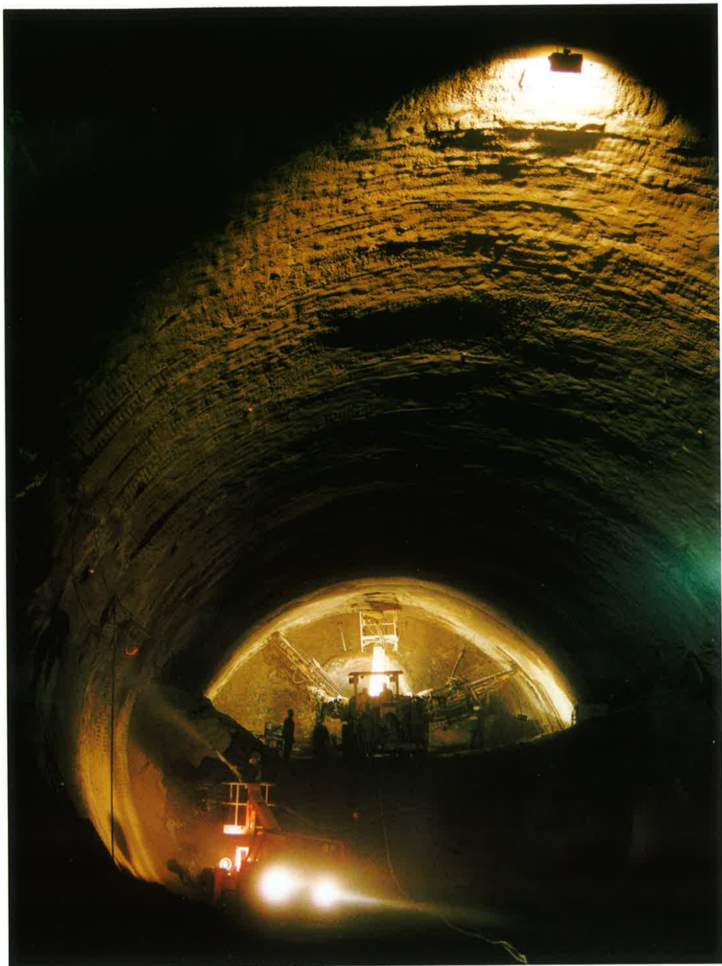
Obr. 1 Ražení s vodorovným členěním průřezu tunelu. Kotvení kaloty a zastříkávání opěří tunelové trouby Excavation with horizontal sequencing of the tunnel cross section. Rockbolting in the top heading and concrete spraying on the tunnel tube footing
