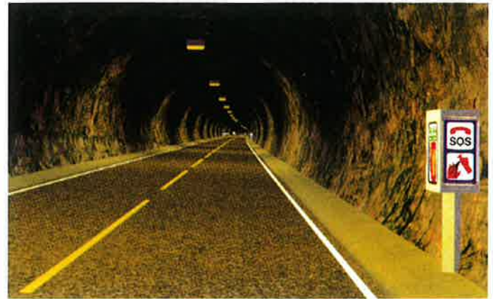
Obr. 5 Bezpečnostní vybavení tunelu Fig. 5 Emergency equipment
