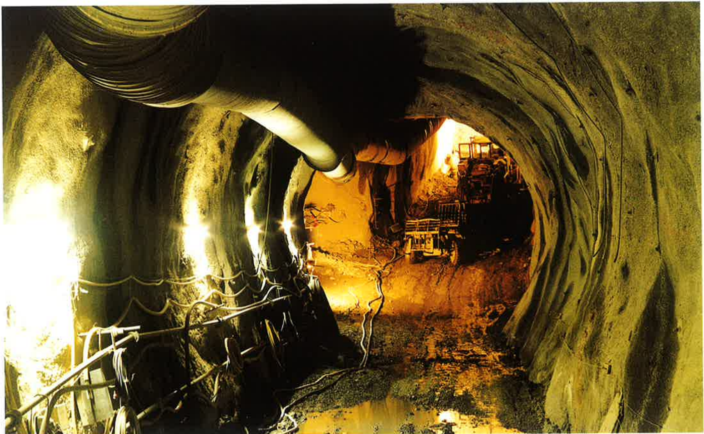
Obr. 4 Fig. 4 Rozvetvenie odtokového tunela ku savkám Bifurcation of the tailrace tunnel to the draught tubes
