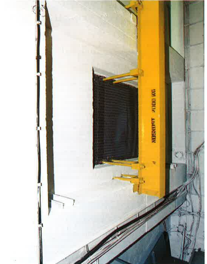
Obr. 3 Fig. 3 Tentýž prostor po těsnící sanaci a s protipožárním nátěrem The space with the shaft after the sealing and fireproof coating completion
