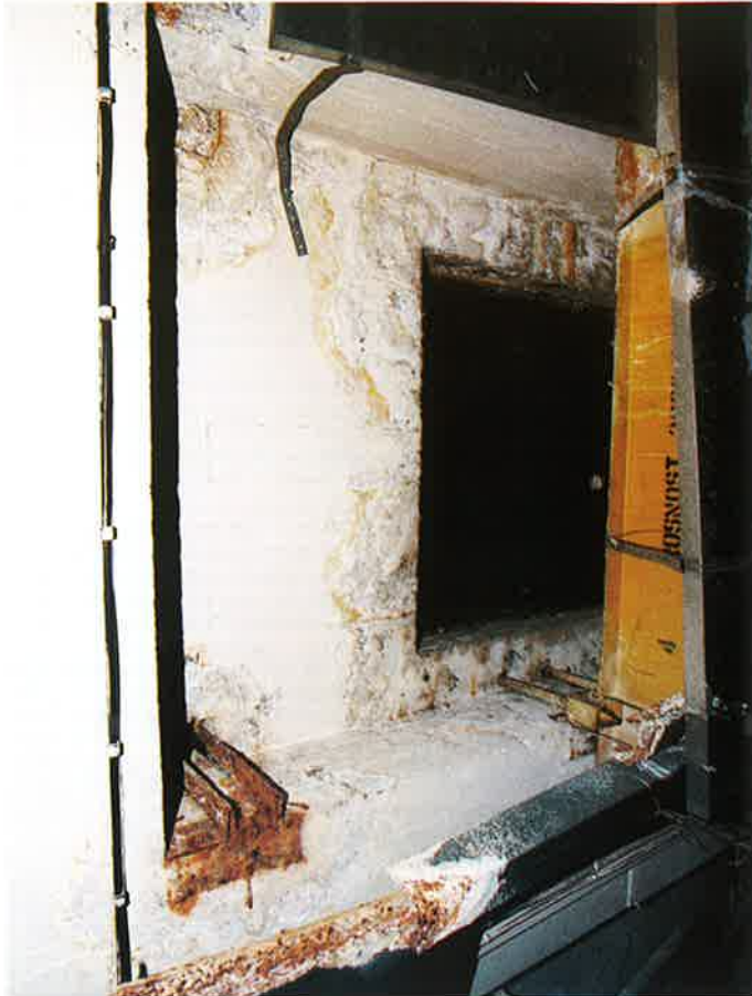
Obr. 2 Fig. 2 Prostor se šachtou před sanací The space with the shaft before refurbishment
