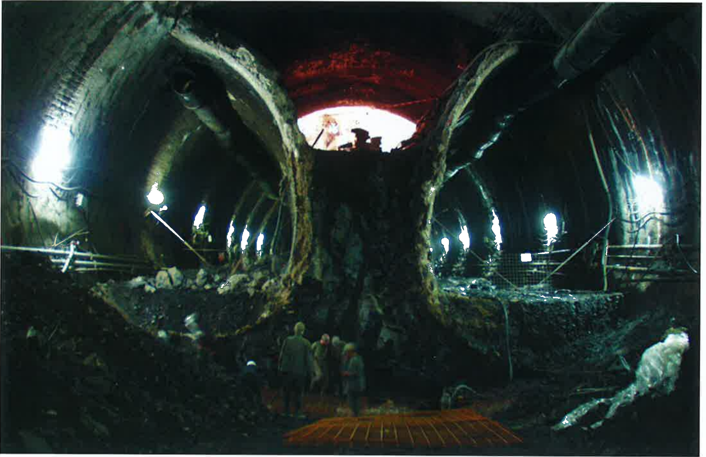
Vertikální členění výrubu třípruhového tunelu Vertical sequencing of the three-lane tunnel excavation
