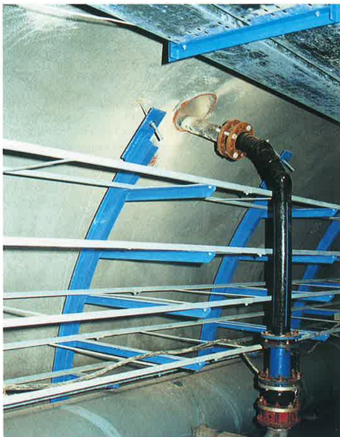
Přípojky vedené v chráničkách zásobují okolní nemovitosti vodou, el. energií atd. Branches routed in pipe sleeves supply neighbouring buildings with water, electricity etc.
