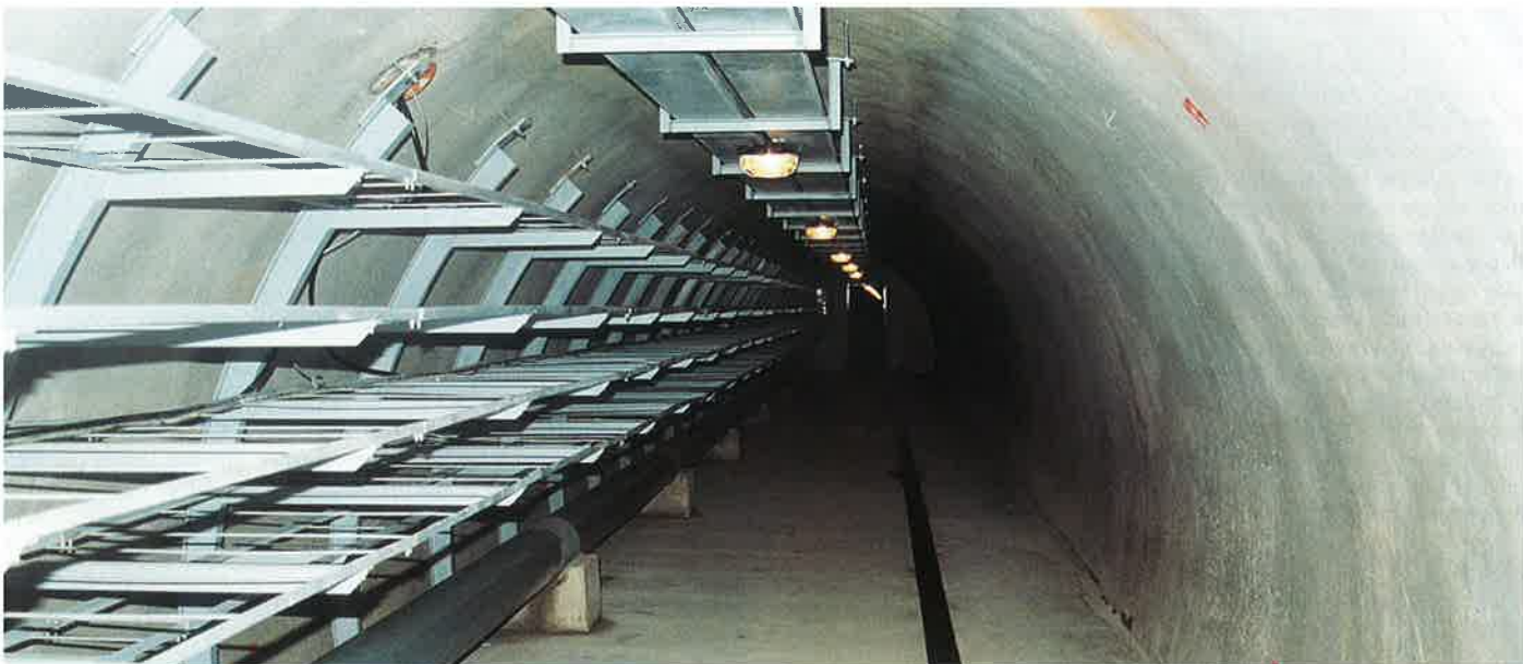
Vystrojený kolektor The collecting tunnel equipped
