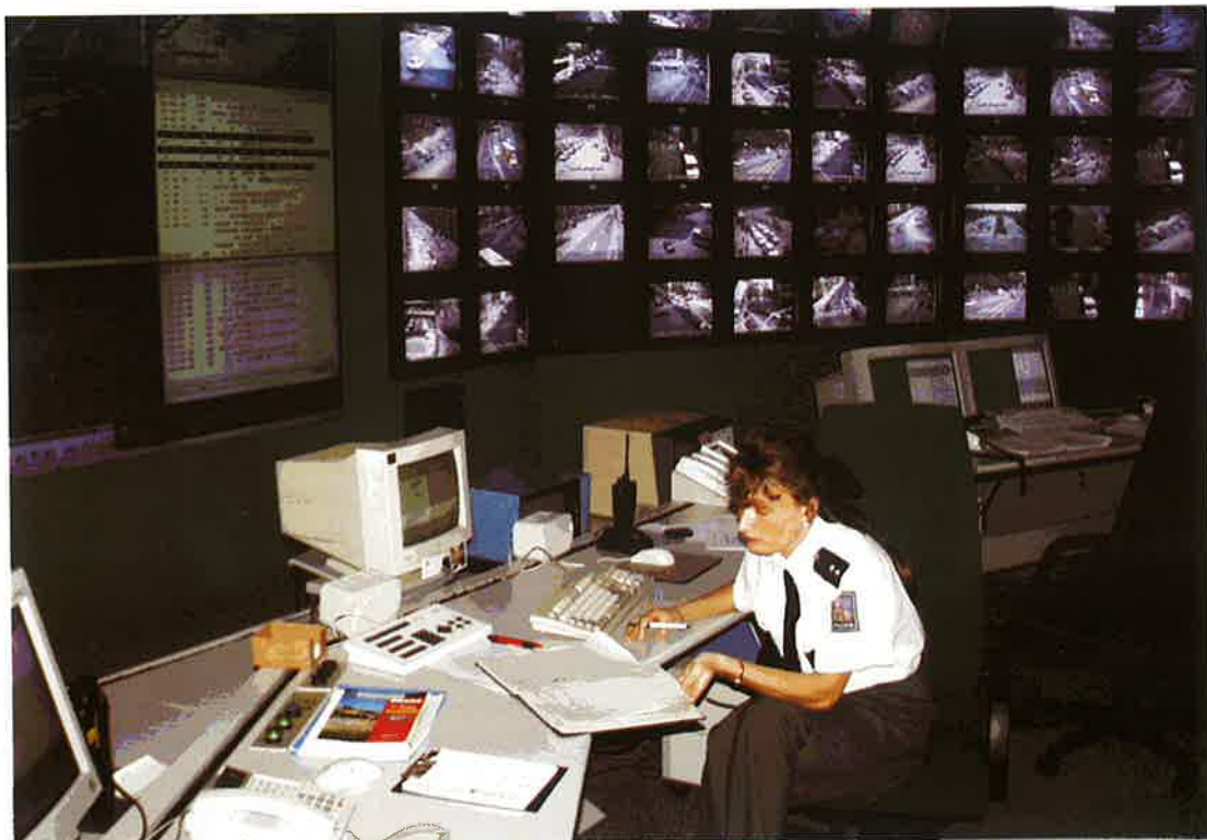
Obr. 3. Hlavní dopravní řídicí ústředna s monitory CCTV dohledu Fig. 3. Major Traffic Management Center with monitors of the CCTV supervision
