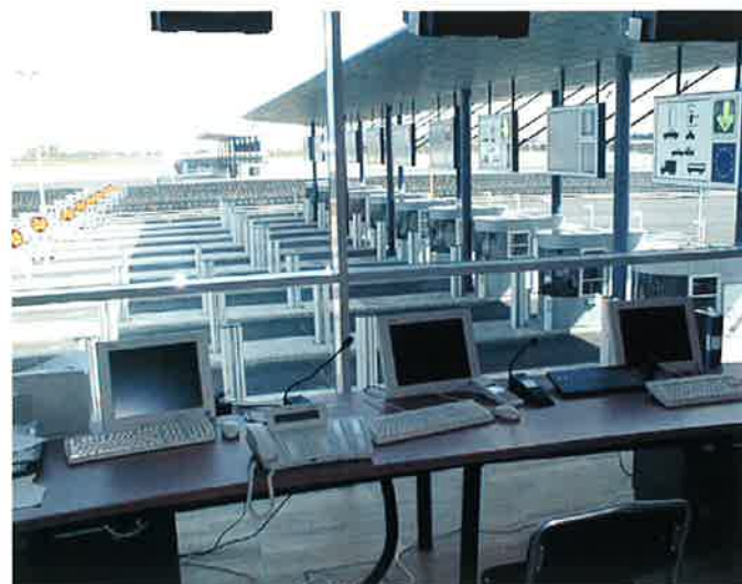
Obr. 8. Pohled do řídicího centra mýtného systému Fig. 8. A view inside the control center of the collection facility
