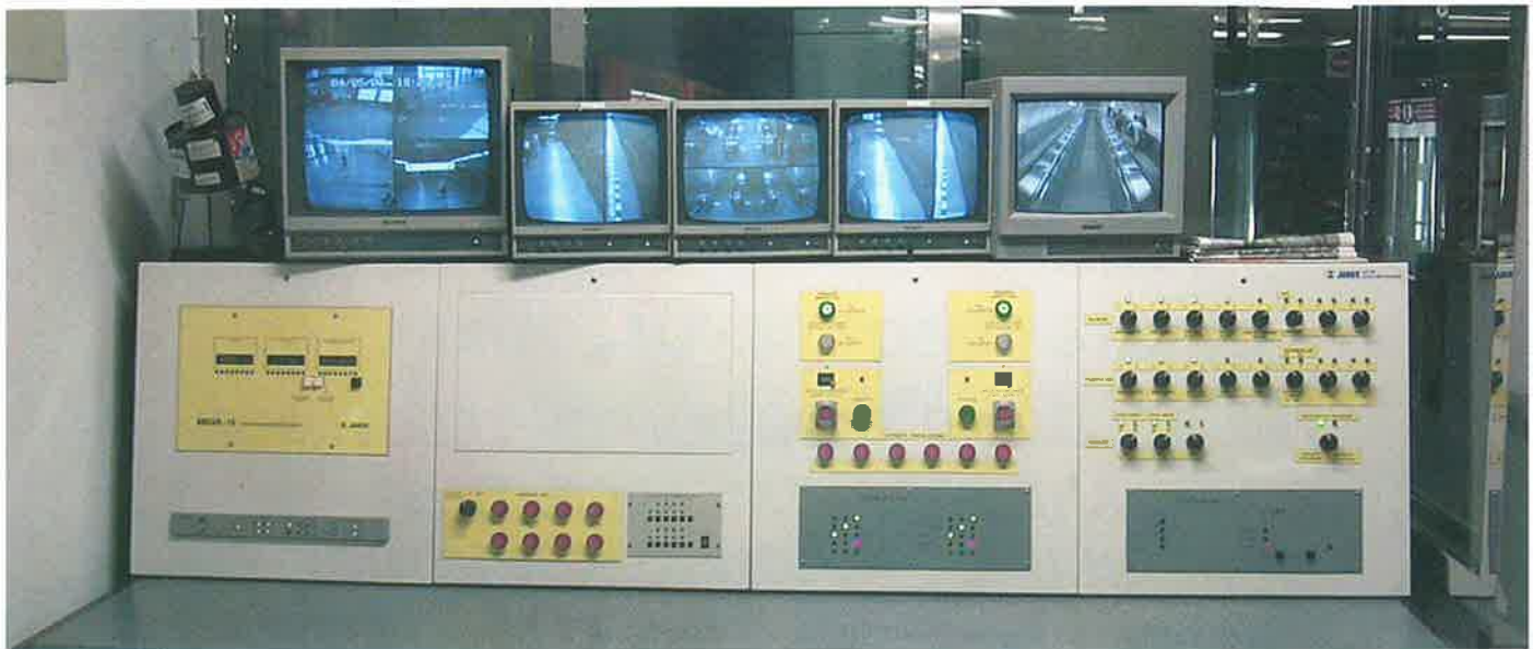
Obr. 1 Monitory sledující provoz ve stanici metra, umístěné v místnosti přepravního manipulanta Fig. 1 Monitors observing the traffic in a metro station, located in traffic operator's room
