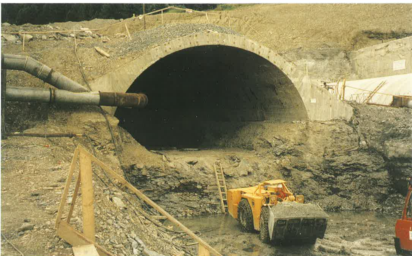
Obr. 3 Tunel Branisko – zahájení ražby jádra Fig. 3 The Branisko tunnel – beginning of the bench excavation
