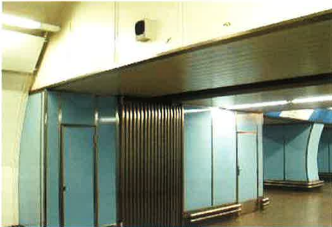
Obr. 8 Akustický majáček signalizující chod eskalátorů Fig. 8 Acoustic beacon signaling a running escalator
