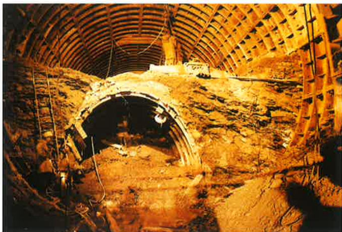
Obr. 5 Ražba spodní části přestupního tunelu na Můstku s předraženu patní štolou Fig. 5 Excavation of the bottom part of the interchange tunnel at Můstek, with pre-excavated side-wall drift
