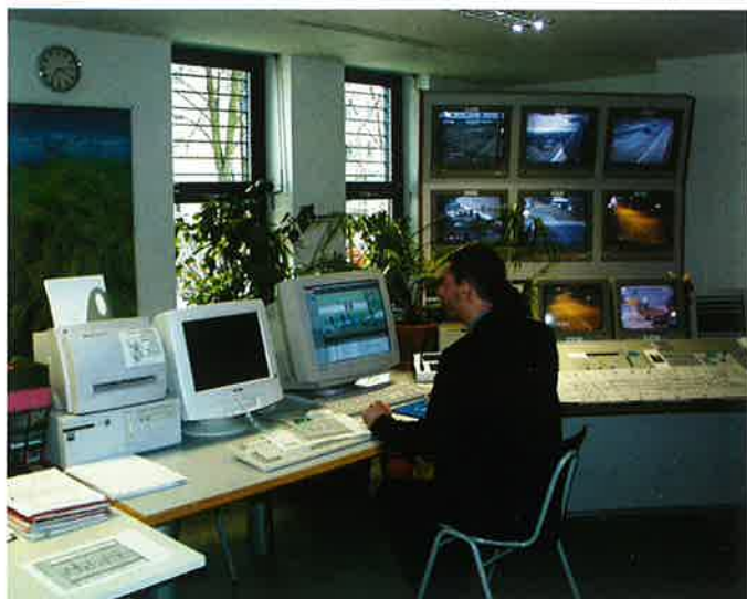
Obr. 6 Lokální velín pro řízení tunelu Orsteil Britz Fig. 6 Local control centre for the Orsteil Britz tunnel management
