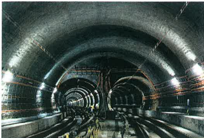
Obr. 2 Dvoukolejný tunel metra. Uložení kabelů ohnivzdorných a kabelů se zvýšenou odolností proti šíření plamene na nosné ocelové konstrukce s dvojháčky. Barva pláště kabelů je oranžová. Foto: Metrostav a. s. Fig. 2 A double-track metro tunnel. Fire resistant cables and cables with enhanced resistance to flame propagation installed on a steel bearing structure with double-hooks. The cable sheathing is orange. Photo: Metrostav a. s.
