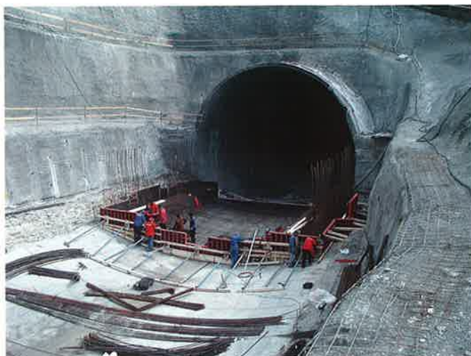
Obr. 11 Úprava základové spáry vyrovnávacím betonem a montáž výztuže Fig. 11 Improvement of the bottom by leveling concrete, and installation of reinforcement
