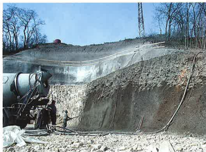
Obr. 8 Jednotlivé etáže byly postupně zajišťovány stříkaným betonem se sítí a kotvami Fig. 8 Individual banquettes were supported step by step by shotcrete with welded mesh and anchors
