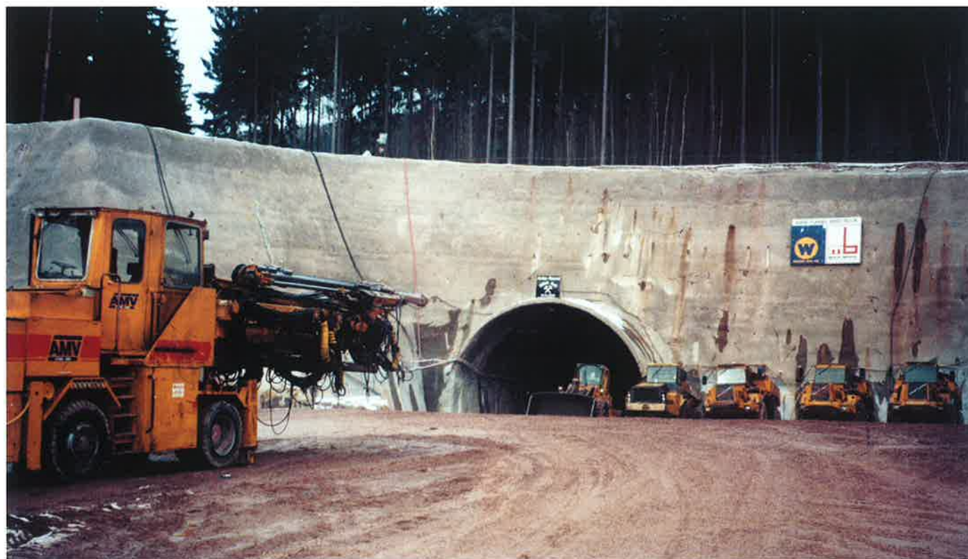
Obr. 1 Dvojicu rúr tunela Berg-Bock razila jedna osádka s tou istou strojovou zostavou
