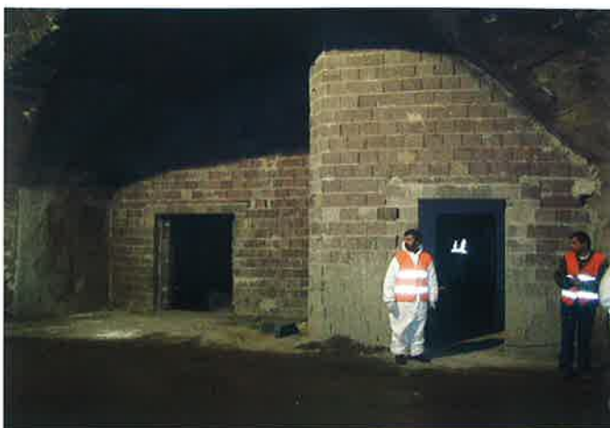
Obr. 8 Únikový východ na italské straně je před dokončením Fig. 8 Emergency exit at the Italian section is before completion
