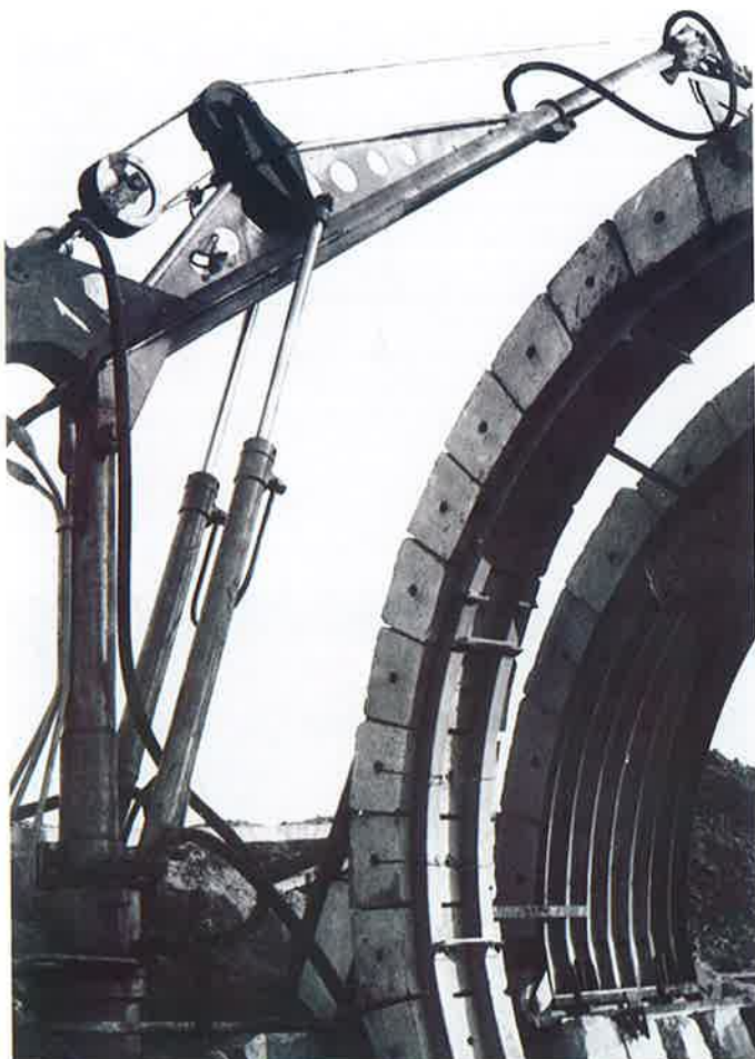
Obr. 3 Šablóna a ukladáč ťažkej blokovej výstuže z betónových tvaroviek s hmotnosťou 270 kg
