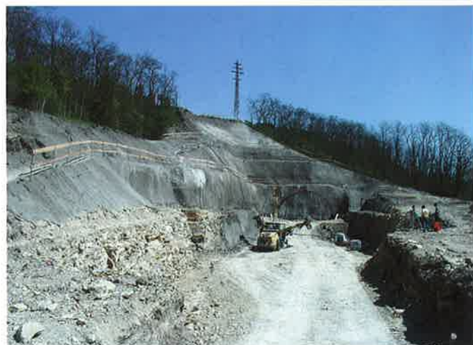
Obr. 9 Odtěžování páté etáže na úroveň jádra tunelu Fig. 9 Excavation of the fifth banquette up to the level of the tunnel core
