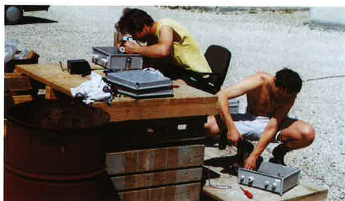
Obr. 4 Příprava k instalaci skříněk řídicího systému na stavebním dvoře Fig. 4 Preparation for installation of boxes of the controlling system at site facility
