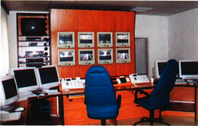
Obr. 2 Dispečink CTD Brněnských komunikací, a. s. Fig. 2 TCC Control Center of the Roads of the City of Brno
