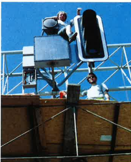
Obr. 5 Oživování funkce koncových jednotek na portále Fig. 5 Activation of functions of the terminal units on the portal
