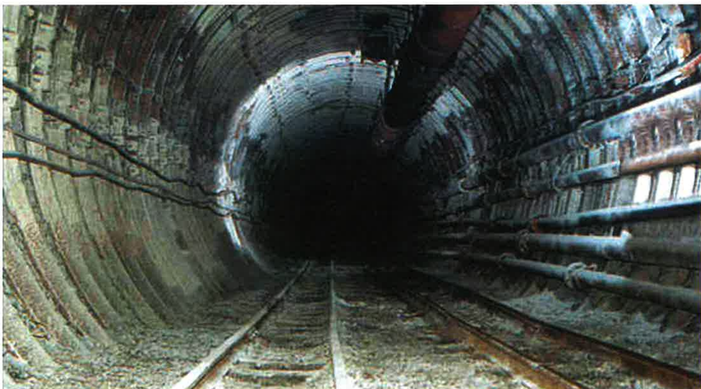
Obr. 1 Spojovací překop ražený pomocí stroje DEMAG TVM-55 Fig. 1 Connecting cross tunnel driven with DEMAG TVM-55
