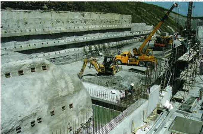
Obr. 4 Zakladanie portálového objektu na východnom portáli, 05/2001 Fig. 4 Construction of the portal building at the eastern portal, 05/2001
