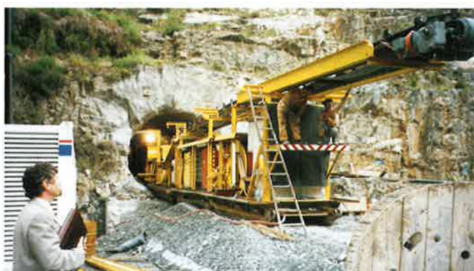
Obr. 3 Čelní pohled na portál štoly a pásový dopravník stroje Fig. 3 Front view of the gallery portal and the TBM belt conveyor
