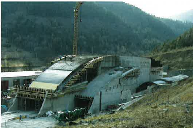
Obr. 5 Výstavba portálového objektu na východnom portáli, 03/2002 Fig. 5 Construction of the portal building at the eastern portal 03/2002
