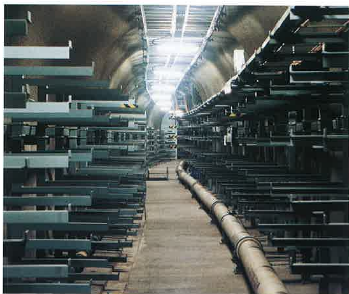
Obr. 3 Vystrojený kolektor 2. kategorie Praha Fig. 3 2nd category utility tunnel with equipment, Prague
