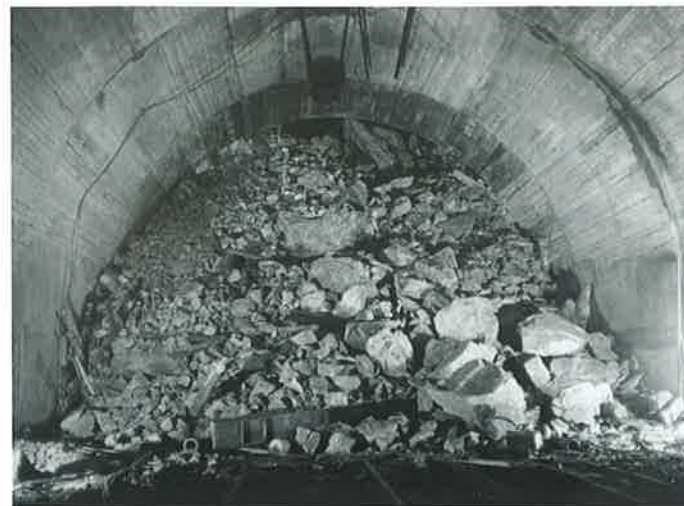
Obr. 7 Závál na tunelu Blanenském IV Fig. 7 The Blansko IV tunnel collapse
