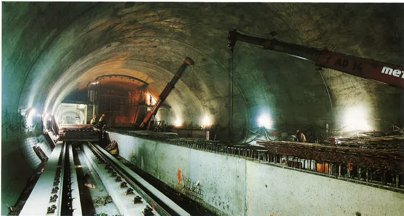
Obr. 4 Trasa pražského metra IVC1 - jednolodní stanice Kobylisy s kolejištěm a výstavbou nástupiště Fig. 4 Metro line IVC1 - Kobylisy one-vault station with rails and platforms under construction
