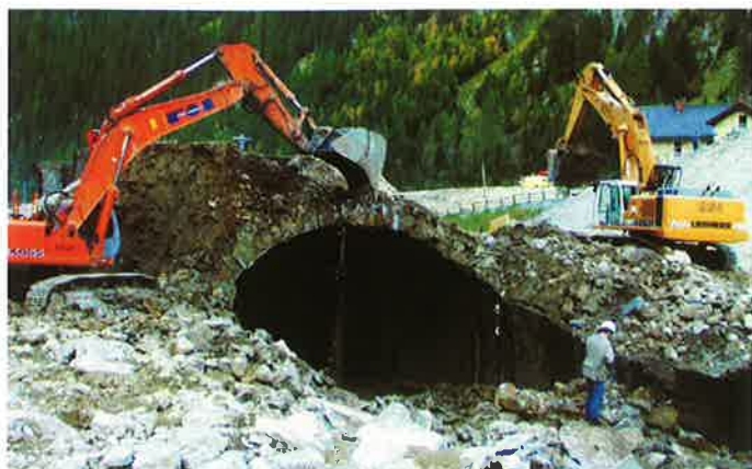
Obr. 4a Bourání části Tauernského železničního tunelu (ditto) Fig. 4a Demolition of a part of the Tauern railway tunnel (ditto)
