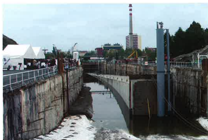
Obr. 14 Tunel metra připravený k vysunutí pod řeku (trasa IVC1 - 2001) Fig. 14 Metro tunnel tube prepared for launching under the river (line IVC1 - 2001)
