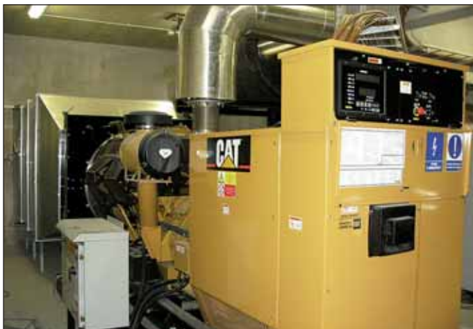
Obr. 3 Náhradní zdroj el. energie dieselaagregát 900 kVA v severním portálovém objektu tunelu Panenská
