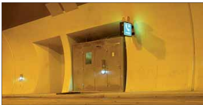
Obr. 2 SOS skříň v tunelu Panenská Fig 2 SOS cabin in the Panenská tunnel
