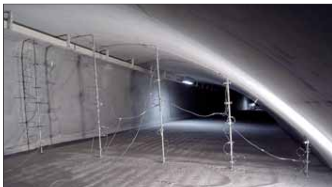
Obr. 4 Měřicí síť v odsávacím kanálu Fig. 4 Measuring grid in exhaust air duct
