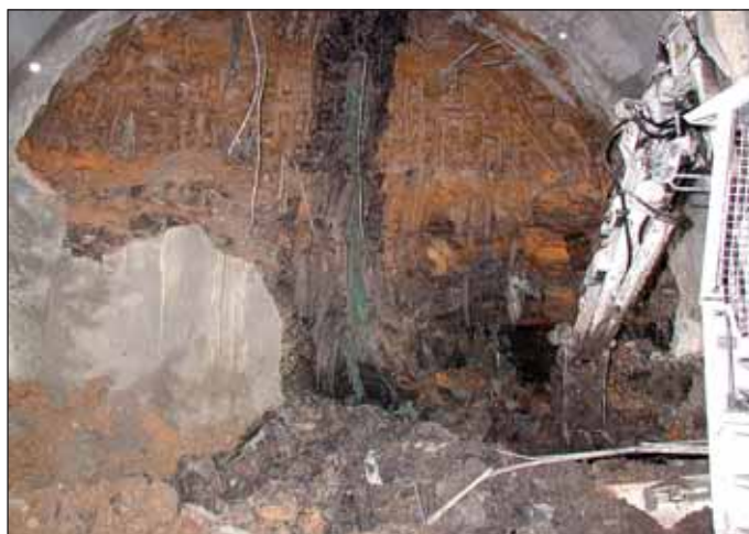
Obr. 4 Čelba tunelu se zavaleným svislým důlním dílem Fig. 4 Tunnel excavation face with the collapsed old shaft
