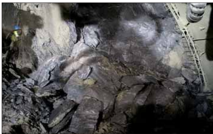
Obr. 4 Nestabilita čelby při nepříznivém sklonu vrstev
