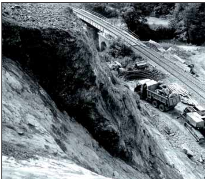
Obr. 3 Sesuv v hloubeném zářezu při rekonstrukci tunelu č. 6 na trati Brno–Česká Třebová
