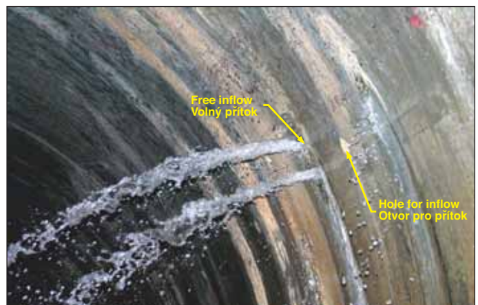
Obr. 13 Přítok vody do tunelu
