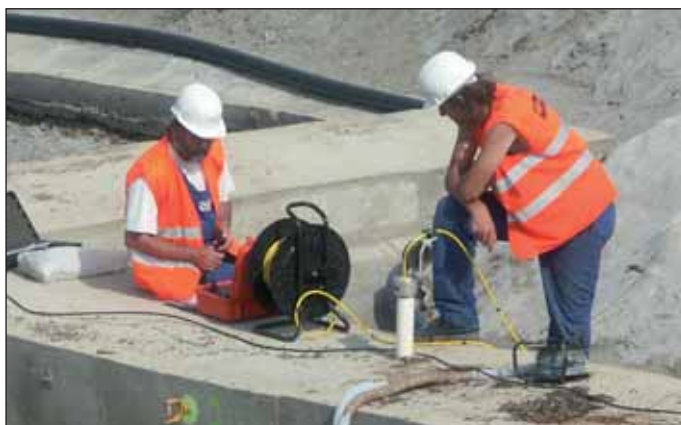
Obr. 7 Inklinometrická měření v pilotě P9 Fig. 7 Inclinometer measurements in P9 pile
