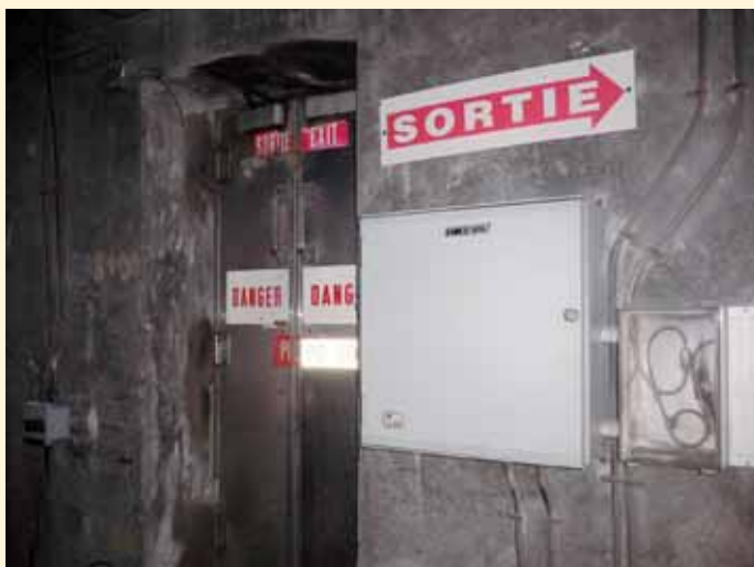
Obr. 2 Dveře pro únik z tunelu do záchranné cesty Fig. 2 Escape door from the tunnel to a rescue route
