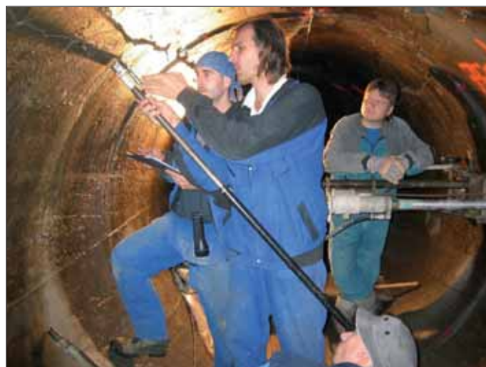
Obr. 14 Měření deformací havarovaného štolového přivaděče Brněnského oblastního vodovodu u portálu Běleč
