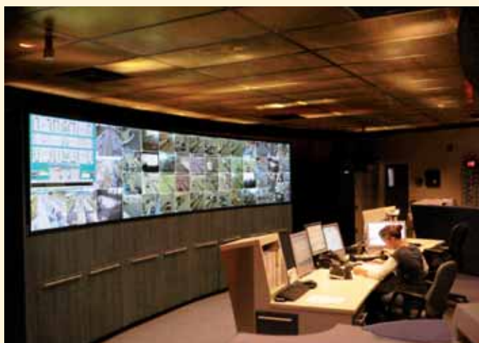
Obr. 1 Prvním krokem modernizace byla výměna řídicího systému Fig. 1 The first step of modernisation was replacing the management system
