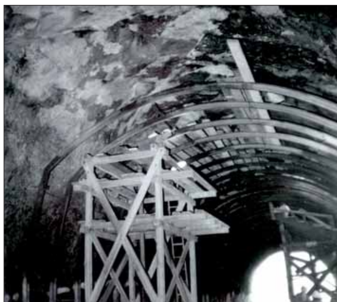
Obr. 1 Provizorní zabezpečení klenby tunelu č. 6 na trati Brno–Česká Třebová po požáru pražcové zakládky ostění
