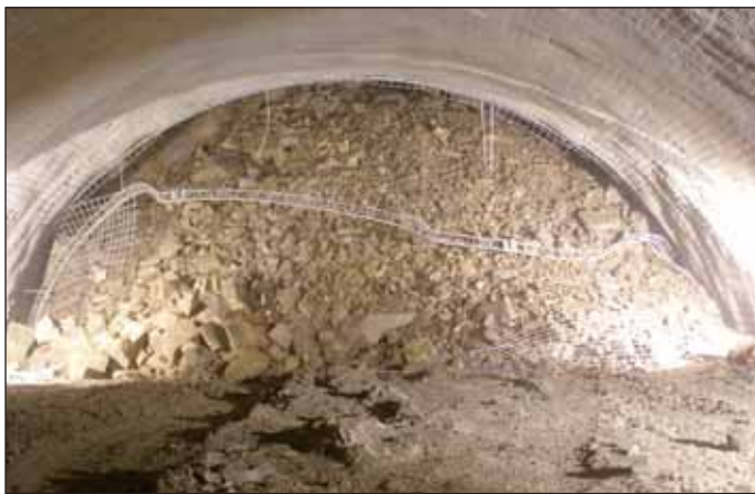
Obr. 6 Objemný nadvýlom z příportálové oblasti lahovického portálu Fig. 6 Large overbreak in the Lahovice portal tunnel section
