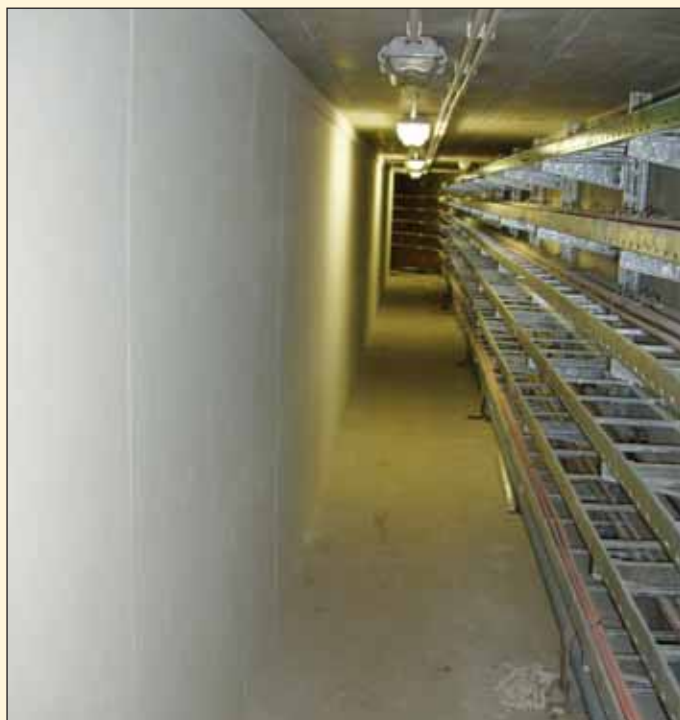
Obr. 1 Tunel Klimkovice – kabelový kanál s podélným oddělením kabelových tras protipožární příčkou PROMATECT® – H
