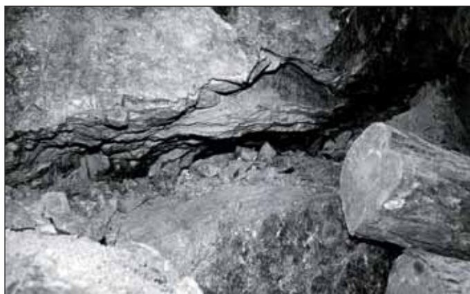
Obr. 8 Rozvolněný masiv v důsledku svahových pohybů (staničení 87 m průzkumné štoly tunelu č. 8)
