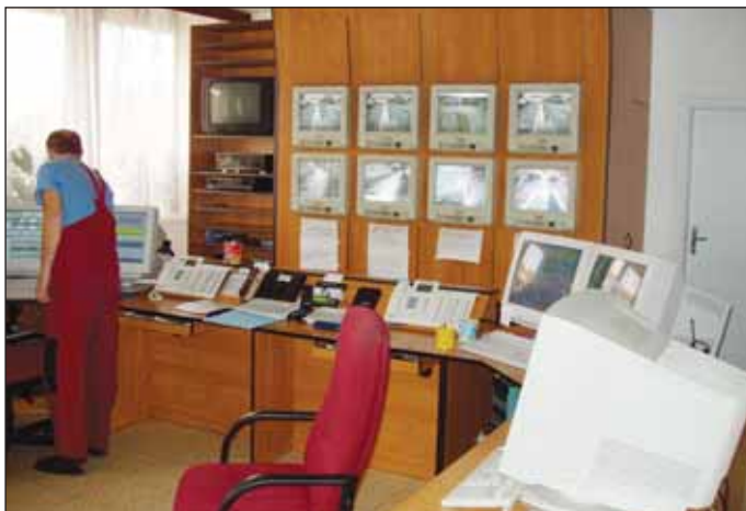
Obr. 3 Nově vybudovaný centrální tunelový dispečink v Brně v roce 1999 Fig. 3 New build tunnel management centre in Brno in 1999
