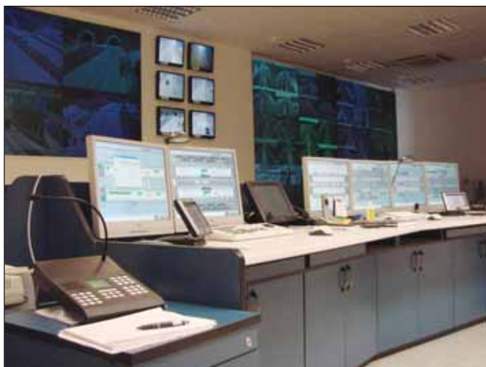
Obr. 11 Aplikace systému ITCC v tunelu Sitina v Bratislavě z roku 2006 Fig. 11 ITCC application at the Sitina tunnel in Bratislava, 2006
