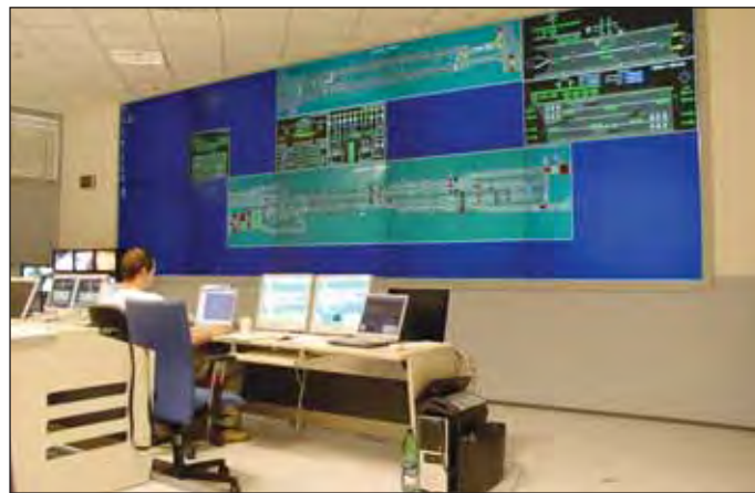
Obr. 7 Rekonstruovaný velín SAT před dokončením tunelu Mrázovka v roce 2004 Fig. 7 Reconstructed SAT control room before the Mrázovka tunnel completion in 2004
