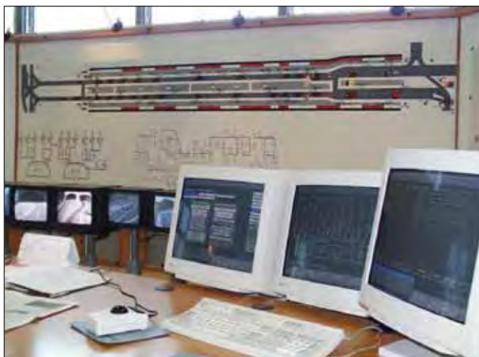
Obr. 1 Původní konfigurace velínu Strahovského automobilového tunelu v roce 1998 s vizualizačním systémem pod operačním systémem UNIX, v pozadí mozaikové tablo zobrazující stav dopravy a technologie v tunelu Fig. 1 Original configuration of the Strahov control centre in 1998, with the visualisation system working under UNIX operational system; a mosaic board showing the state of traffic and equipment in the tunnel is in the background
