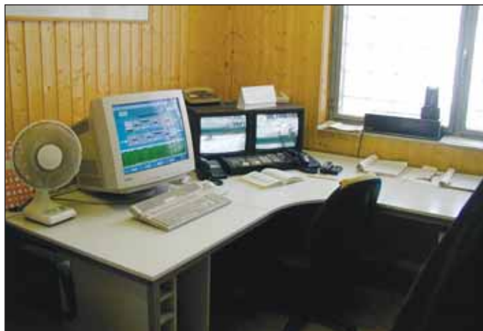
Obr. 4 Rekonstruovaný velín Těšnovského automobilového tunelu, rok 2000 Fig. 4 Reconstructed Těšnov automobile tunnel control centre, 2000
