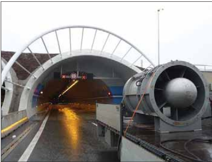
Obr. 1 Mobilní ventilátor před portálem tunelu (foto Ing. Jiří Zápařka) Fig. 1 A mobile fan in front of the tunnel portal (photo courtesy of Jiří Zápařka)
