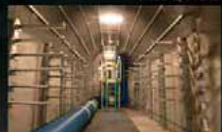
Utility collector tunnel on Václavské náměstí - C line, Prague
