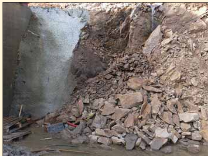
Obr. 2 Nestabilita skalní stěny stavební jámy hloubeného tunelu Votice Fig. 2 Instability of a rock wall of the construction trench for the Votice cut-and-cover tunnel
