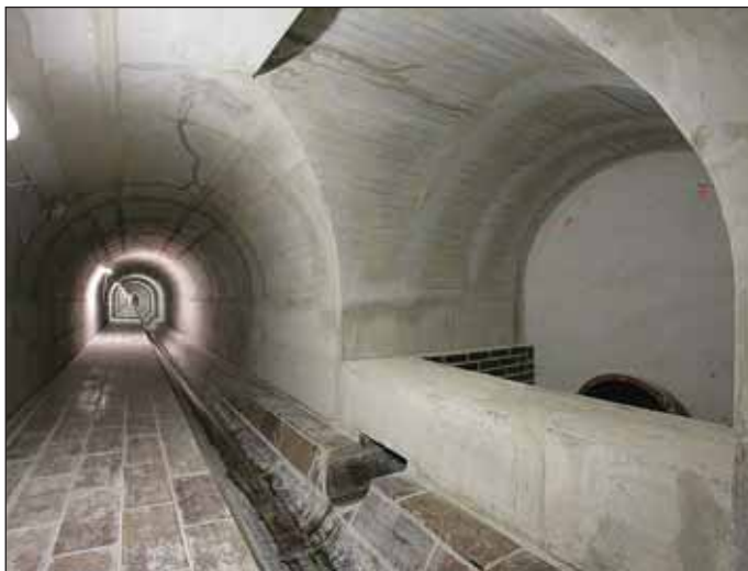
Obr. 5 Odbočka ke spadištové šachtě SP2 Fig. 5 Branch to drop manhole SP2
