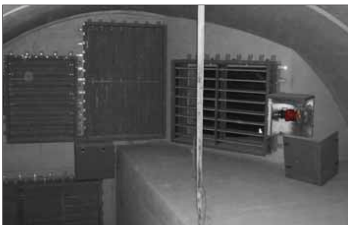
Obr. 7 Uzavírací klapky ve svislé poloze oddělující pravý tunel Komořany od levého, který je součástí SOKP
