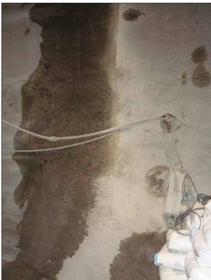
Obr. 5 Výrony a poruchy těsnosti primárního ostění Fig. 5 Leaks and defects of the primary lining tightness
