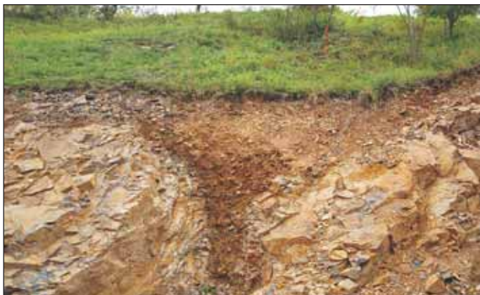
Obr. 1 Tektonická porucha zastižená při zahájení ražby vinného sklepa Fig. 1 Tectonic disturbance encountered at the beginning of the wine cellar excavation
