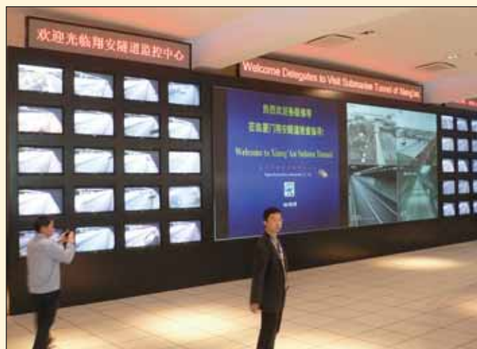
Obr. 4 Řídicí dispečerské středisko tunelu Xiangan Fig. 4 Xiangan tunnel control centre
