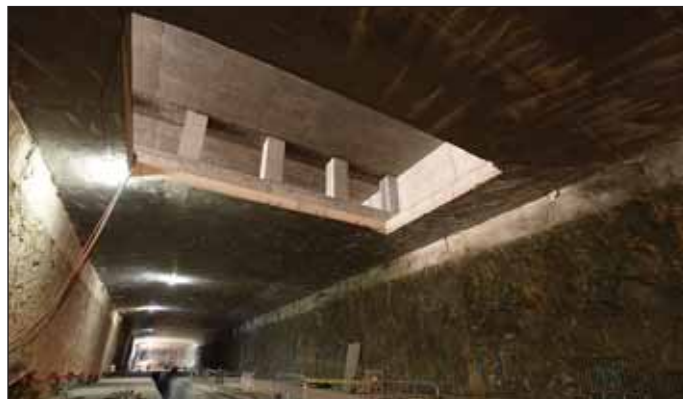
Obr. 8 Otvor požárního větrání v dilataci D4 JTT na Letné Fig. 8 An opening for fire ventilation in expansion block D4, STT in Letná
