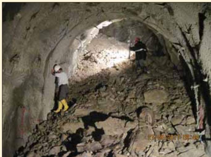
Obr. 5 Mimořádná událost – zával na štolě Gyalthum Fig. 5 Incident – a collapse in Gyalthum gallery
