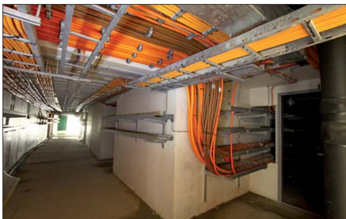
Obr. 3 Kabelové rozvody pod vozovkou u tunelové propojky TP B10 (foto Jakub Karlíček)
