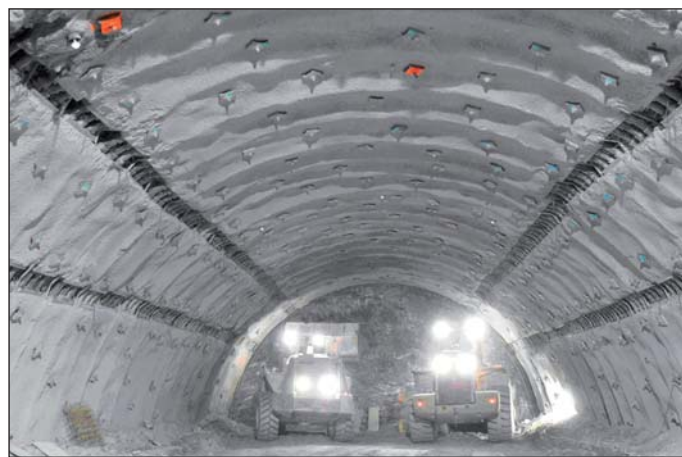
Obr. 5 Poddajná výstroj u druhé trouby Tauernského tunelu (foto PORR) Fig. 5 Ductile support at the second tube of the Tauern tunnel (Photo: PORR)
