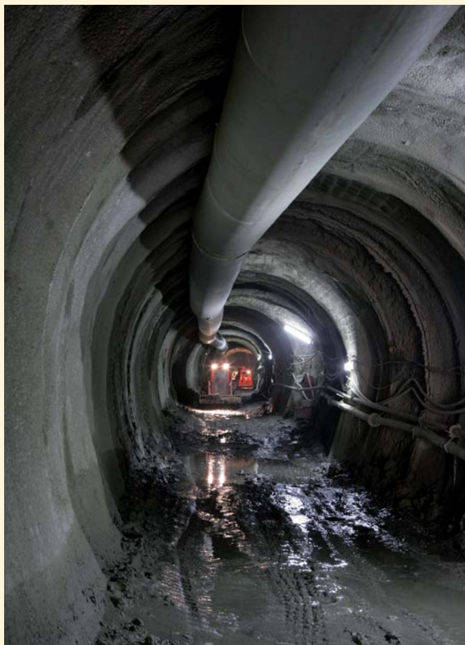
Odpadní štola protipovodňové ochrany v Jablonci (foto Josef Husák) The outlet tunnel of the flood prevention system in Jablonec (photo courtesy of Josef Husák)
