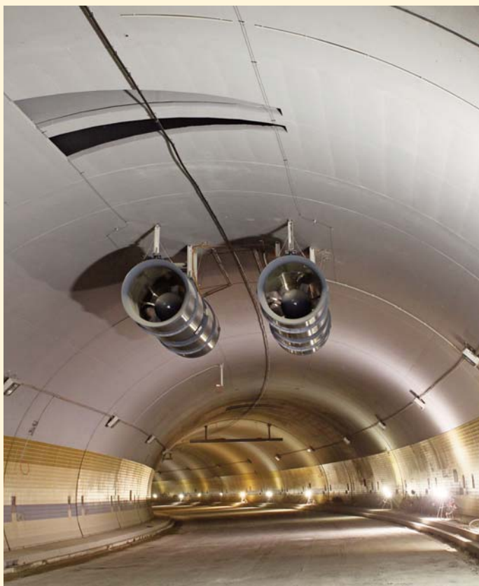
Tunel Blanka: Třípruhový ražený tunel s dvojicí proudových ventilátorů a štěrbinami pro odvod kouře při požáru (foto Jakub Karlíček)
