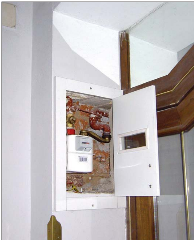
Obr. 4 Oslabení nosného pilíře výklenkem pro plynoměr Fig. 4 Weakening of the structural pillar by a gas measurement niche
