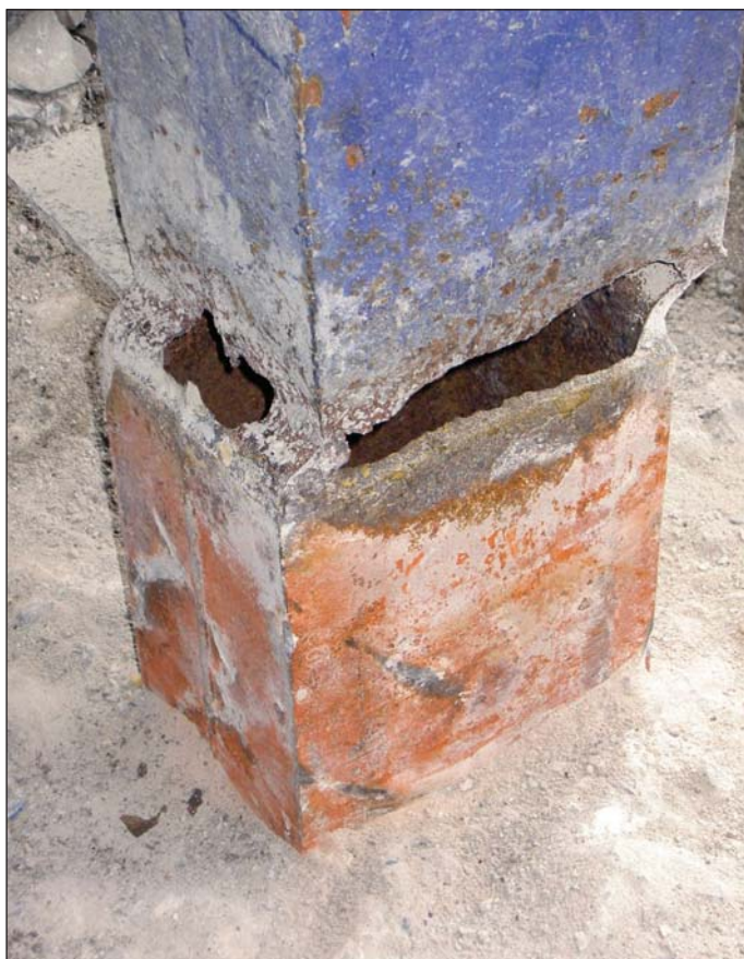
Obr. 5 Koroze nosného ocelového sloupu Fig. 5 Corrosion of the structural steel pillar
