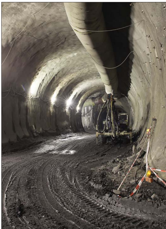
Obr. 2 Trhliny a dodatečné kotvení na přechodu TGC 4 – strojovna Fig. 2 Cracks and additional anchoring at the passage of TGC 4 to the cavern
