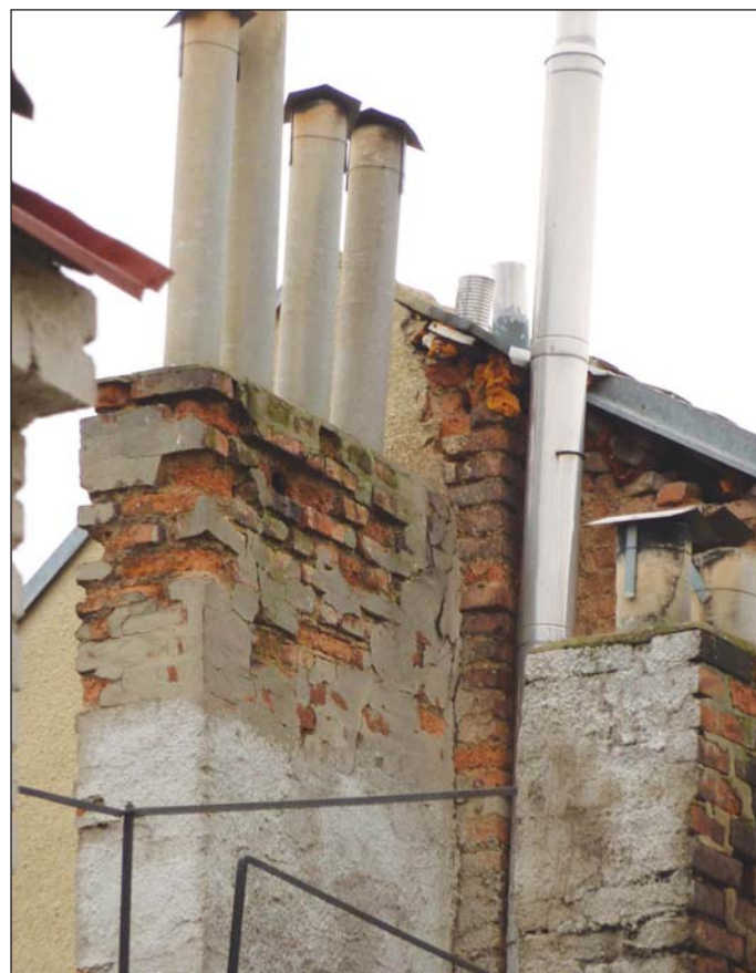
Obr. 6 Zvětralé zdivo komínového tělesa Fig. 6 Weathered masonry of the chimney body
