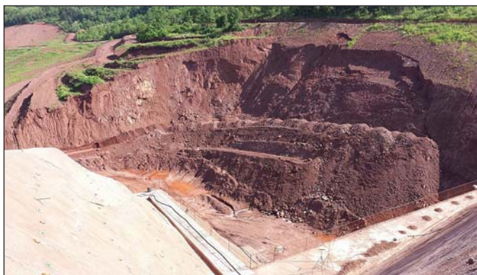
Obr. 2 Pohled na nestabilní levý svah západního portálu Fig. 2 View of the instable left-hand slope at the western portal
