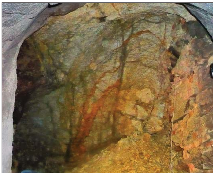
Obr. 2 Fotodokumentace nezajištěného výrubu podzemního prostoru – dokumentační bod č. 1
