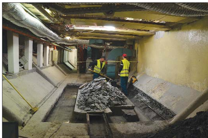
Obr. 10 Po vybourání drážek pro základy definitivních nosných konstrukcí v podlaží pod nástupištěm došlo k jejich rychlému zatopení průsakovou vodou
