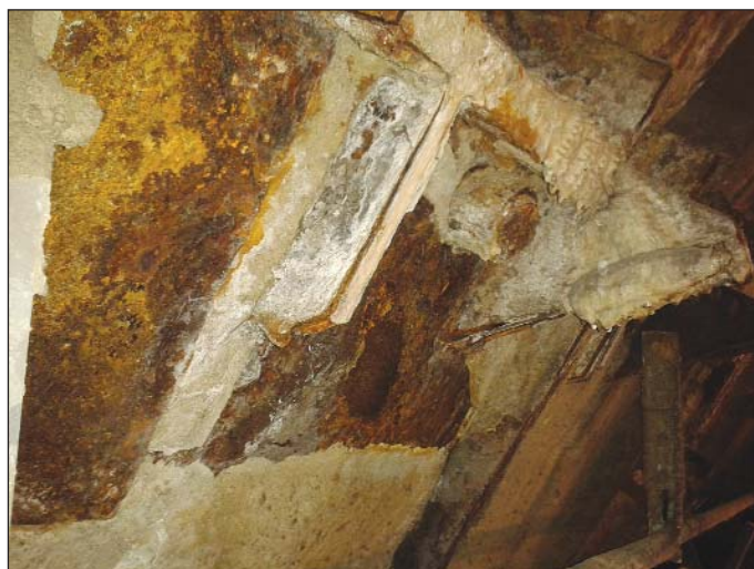
Obr. 12 Korozi nejvíce zasažená část nosného ocelového průvlaku na nástupišti stanice
