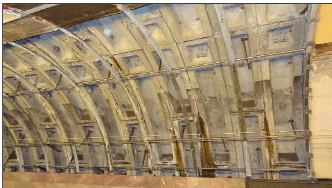
Obr. 13 Po demontáži prvků opláštění stanice byl zjištěn nevyhovující stav železobetonového ostění
