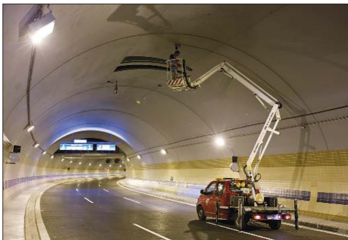
Obr. 1 Komplexní zkoušky v Bubenečském tunelu Fig. 1 Comprehensive tests in the Bubeneč tunnel
