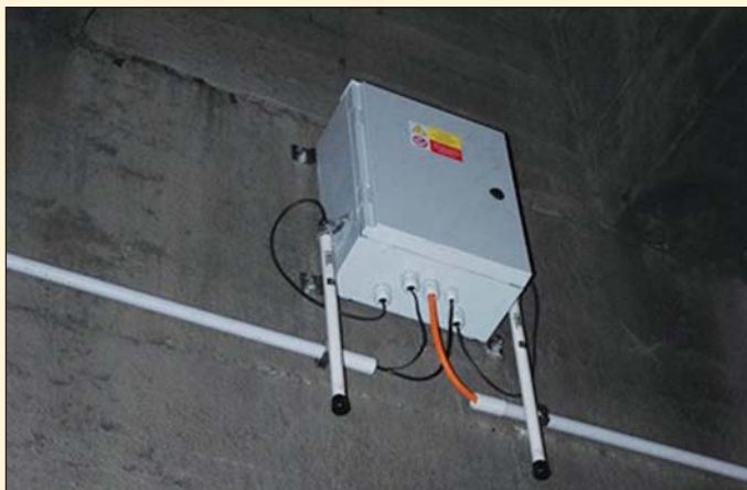
Obr. 1 Rozváděč a antény interaktivního systému Fig. 1 Switchboard and aerial of the interactive system
