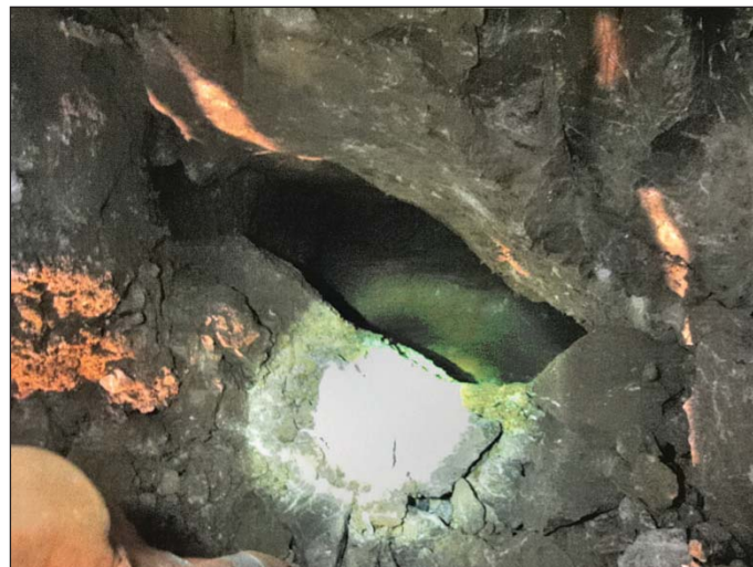
Obr. 3 Otvorená krasová dutina v dne kaloty v staničení 1587,8 tm Fig. 3 Open karst cavity at the top heading bottom at tunnel chainage m 1587.8
