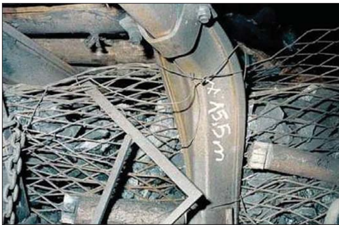
Obr. 2 Detail deformace průřezu TH 29 [3]
