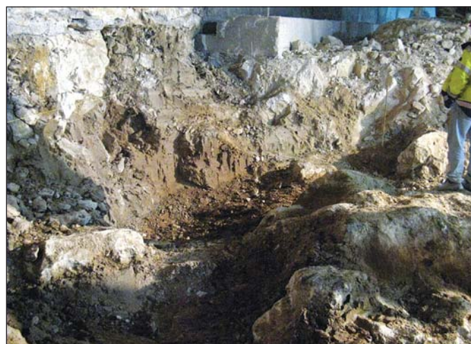
Obr. 9 Kaverna vyplnená ílovitou výplňou v dne tunelovej rúry (280 až 290 tm) Fig. 9 Cavern filled with clay at the tunnel tube bottom (tunnel chainage m 280 to 290)
