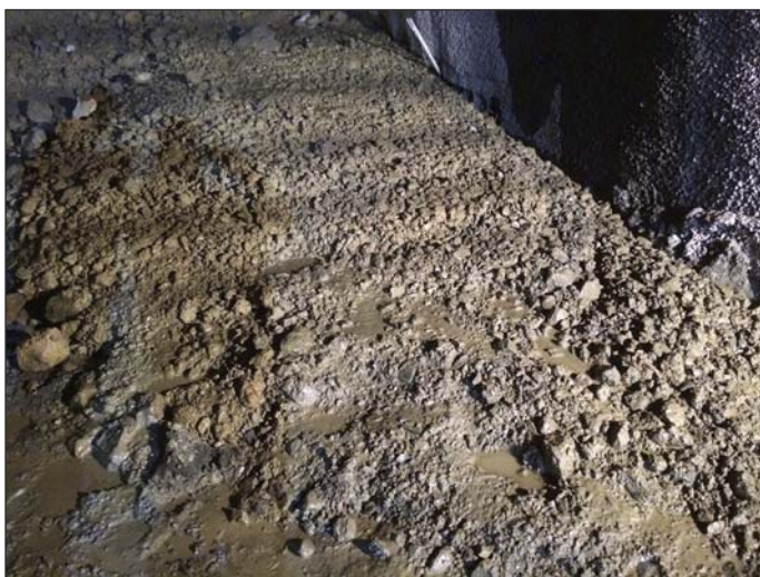
Obr. 7 Zával, november 2015, vtečenie zvodného materiálu do priestoru tunela, staničenie km 0.313
