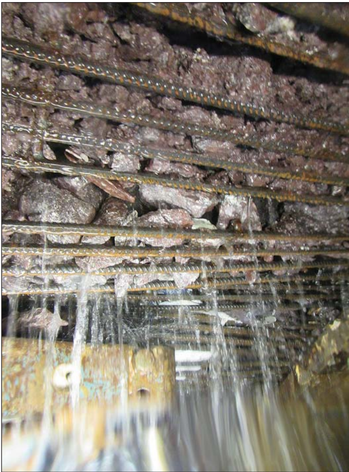
Obr. 8 Materiál tektonické poruchy s vyplavenými jemnými částicemi, tvořící stálé zatížení působící na výstroj McNally u stropu výrubu Fig. 8 Fault material with fines washed out forming dead load on McNally support in the roof
