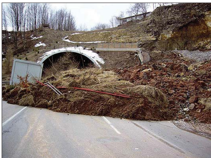
Obr. 13 Zřícení svahu u tunelu Hřebeč
