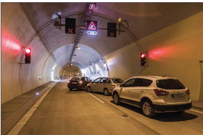
Obr. 6 Simulácia dopravnej nehody a reakcia centrálneho riadiaceho systému tunela na dopravné značenie Fig. 6 Simulation of a traffic accident and a central managing system reaction on traffic signs
