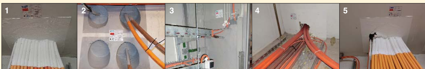
Obr. 1, 2 Provozuschopné ucpávky, Obr. 3, 4 a 5 Poškozené ucpávky
