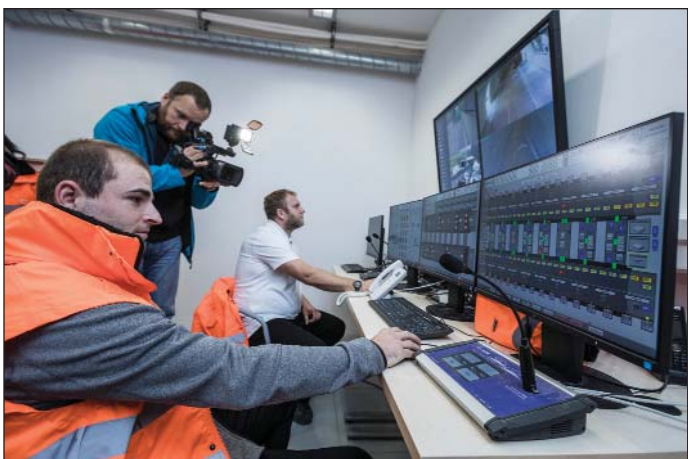
Obr. 3 Operátorské pracovisko prevádzkovo-technologického objektu na západnom portáli – vizualizácia riadiaceho systému Fig. 3 Operator's workplace of the operation-technology object at the western portal – visualisation of the control system
