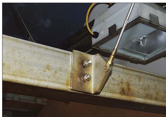
Obr. 8 Bimetalická koroze (nerez + pozink. podložky) Fig. 8 Bimetallic corrosion (stainless steel + galvanised washers)
