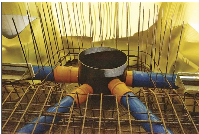
Obr. 4 Šachta čistění boční drenáže a drenáže odvodnění pláně vozovky Fig. 4 Manhole on side-wall drainage and roadway sub-grade drainage
