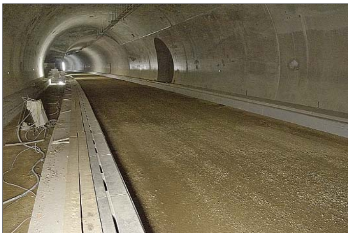
Obr. 7 Voda stojící na povrchu šterkodrti Fig. 7 Water standing on the crushed gravel layer
