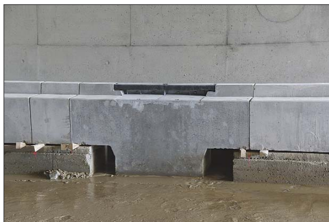
Obr. 12 Oslabení základového pásu v místě samozhášecího kusu
