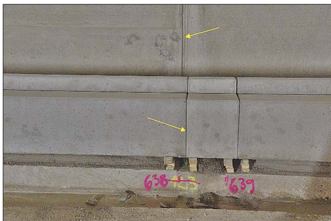
Obr. 11 Průběžnost spár mezi bloky betonáže definitivního ostění a štěrbínovými žlaby
