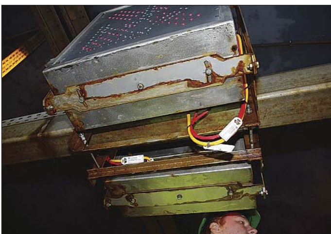
Obr. 7 Pružová signalizace (bimetalická koroze – nerez + ocel) Fig. 7 Lane-use signals (bimetallic corrosion – stainless steel + steel)
