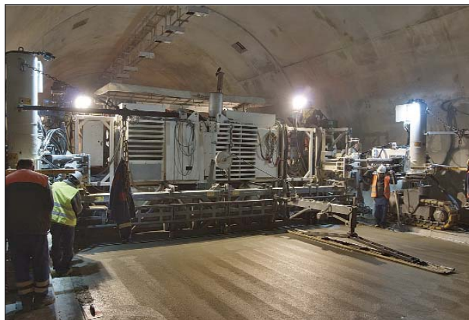
Obr. 15 Povrch CB krytu před dalšími úpravami
