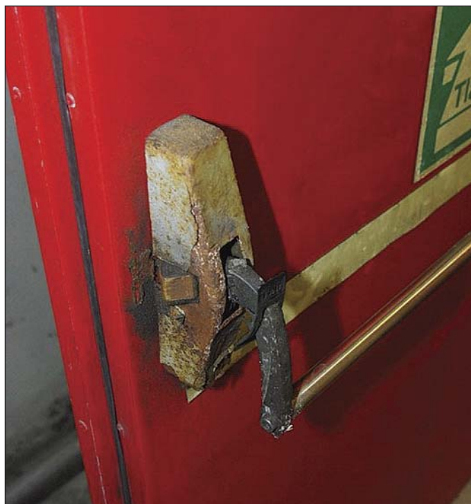
Obr. 4 Panikové kování dveří tunelové propojky (slitina barevných kovů) Fig. 4 Panic fittings of cross passage door (an alloy of non-ferrous metals)
