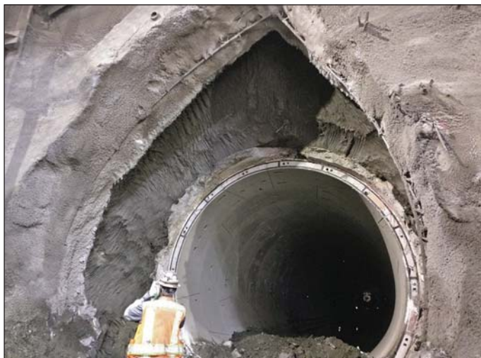
Obr. 9 Lokálně zvýšený výrub kolem segmentového ostění raženého tunelu Fig. 9 Local overexcavation around the bored tunnel precast lining
