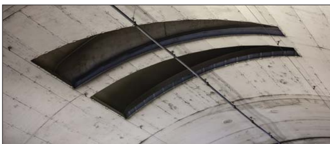
Obr. 1 Odsávací štěrba systému požárního větrání v klenbě stropu raženého tunelu
