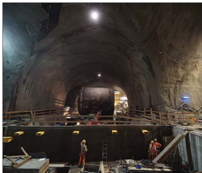
Obr. 9 Část L1 stroje ve staničním tunelu Fig. 9 L1 part of the TBM in a station tunnel
