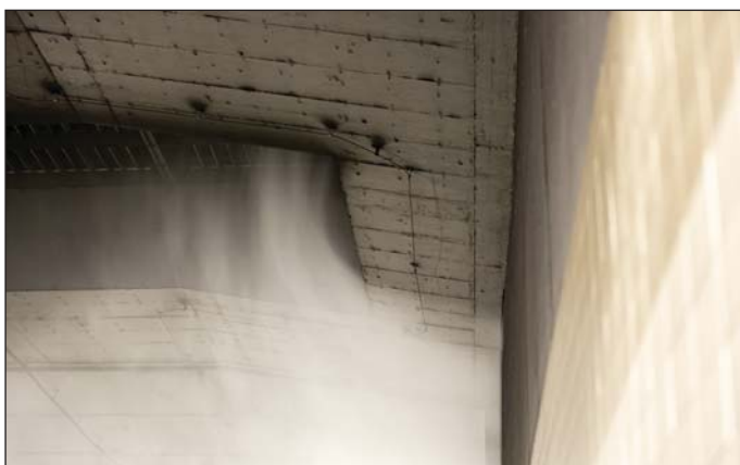
Obr. 5 Nasávací otvor ve stropě hloubeného tunelu
