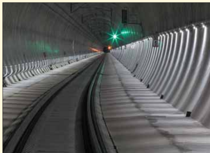
Obr. 7 Pevná jízdní dráha, tunel Ejpvovice, MTÚ Rokycany – Plzeň
