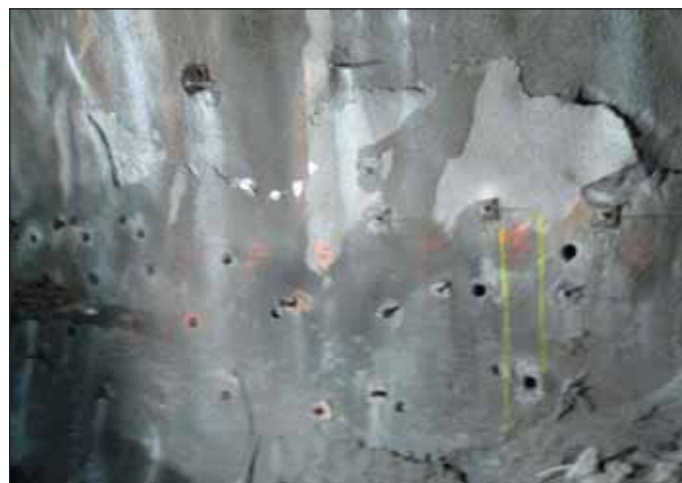
Obr. 8.2 Smykové trhliny v ostění Fig. 8.2 Shear cracks in the lining
