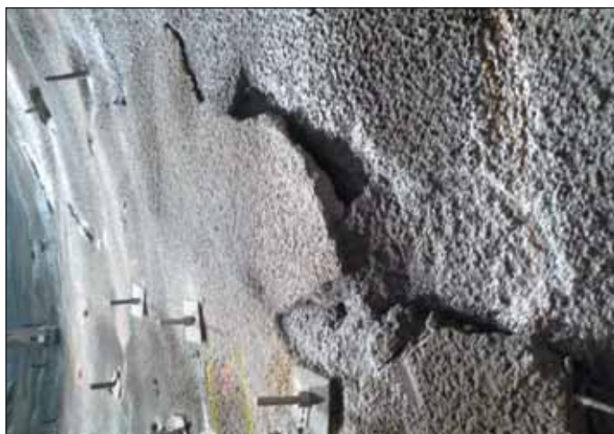
Obr. 8.1 Smykové trhliny v ostění Fig. 8.1 Shear cracks in the lining
