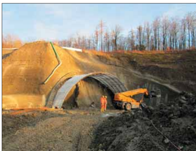
Obr. 8 Předštítok jižní tunelové trouby v západním zářezu (nad ním jsou patrné trhliny vzniklé pohybem svahu)
