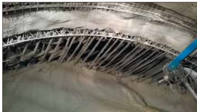
Obr. 4 Vyspávání horniny v přístropí kaloty Fig. 4 Loose ground falling from the top heading roof
