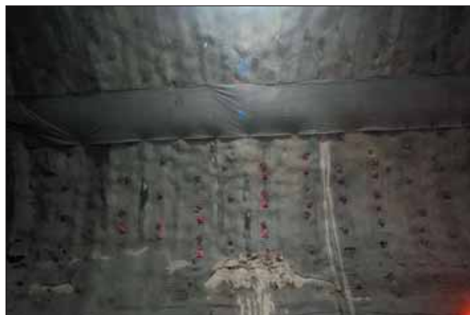
Obr. 4 Překotvení ostění poškozeného horninovým tlakem Fig. 4 Additional anchoring of the lining damaged by rock pressure
