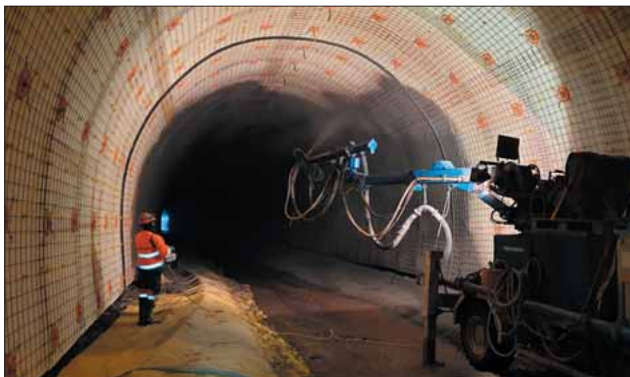
Obr. 8 Aplikace stříkaného betonu na KARI síť Fig. 8 Application of shotcrete on KARI welded mesh
