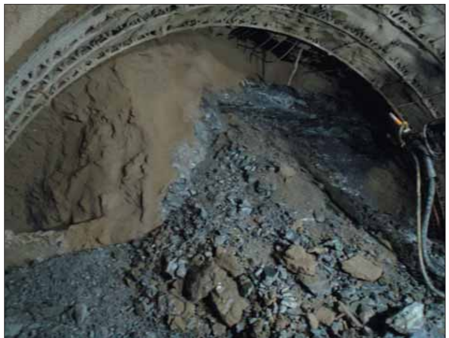
Obr. 3 Pohled na nadvýlom v TM 388,2 Fig. 3 View of overbreak at TM 388.2
