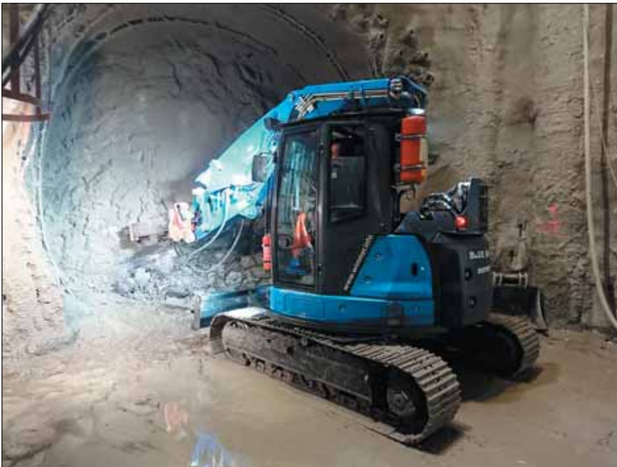
Obr. 7 První metry ražby pomocí speciálního tunelbagru Fig. 7 Initial metres of excavation using a special tunnel excavator
