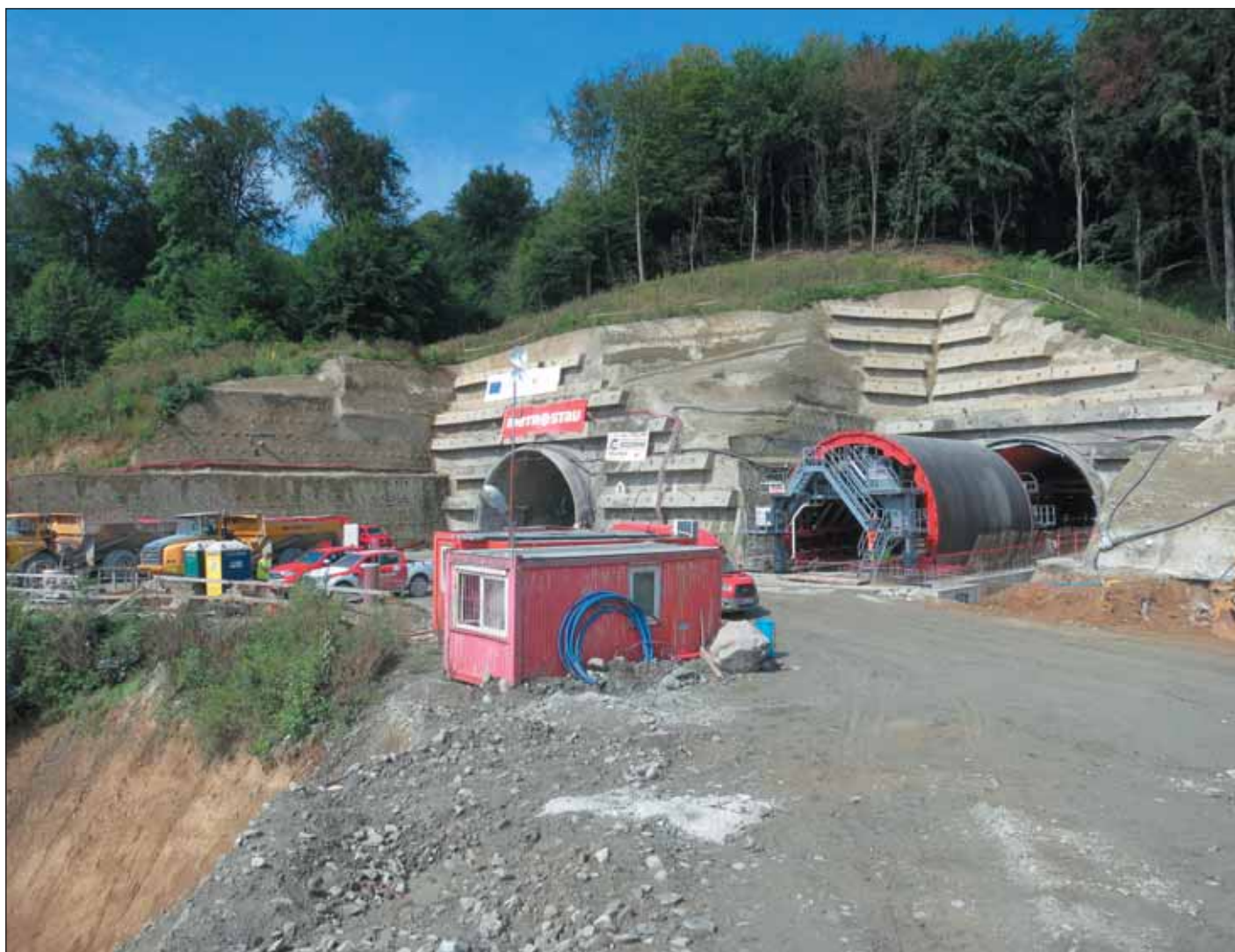
Obr. 8 Bednicí vůz pro betonáž horní klenby Fig. 8 Formwork traveller for concreting the upper vault
