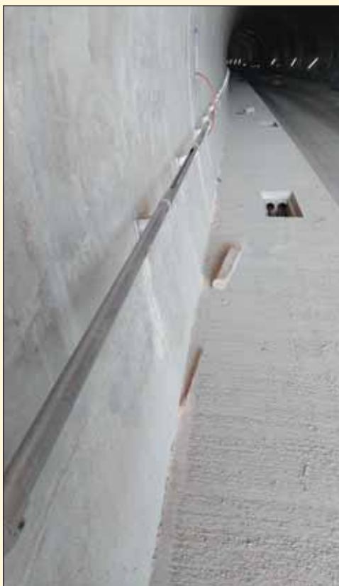
Obr. 9 Bezpečnostné madlo v tuneli Milochovo Fig. 9 Safety handrail in Milochovo tunnel
