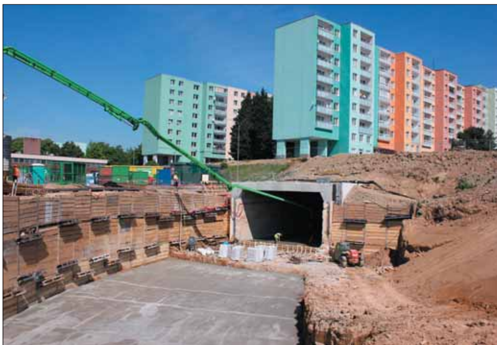
Obr. 2 Jáma objektu SO 601 a betonáž definitivního dna prvního dilatačního celku SO 602; červen 2021 Fig. 2 Pit for SO 601 structure and concreting the final bottom of the first expansion block of SO 602; June 2021
