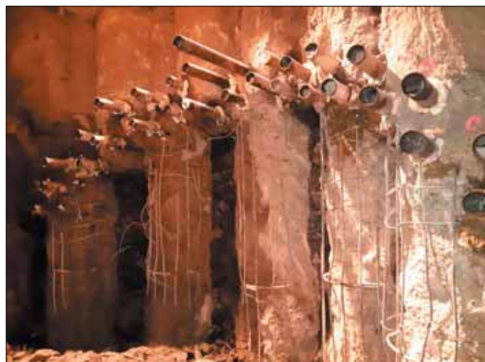
Obr. 8 Mikropilotový deštník – před rozrážkou do štoly Fig. 8 Canopy tube pre-support – before excavation of the side stub for the gallery
