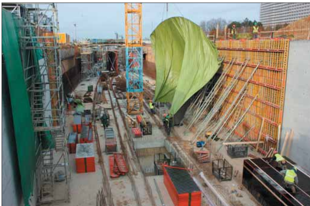
Obr. 8 Pohled od výtahové šachty do stanice Nová Jihlavská; příprava na zimní betonáž pohledových betonů stěn stanice; leden 2021
