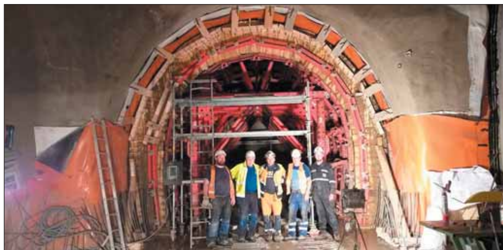
Obr. 10 Betonáž horní klenby přestupní chodby Fig. 10 Concreting the upper vault of the transfer corridor
