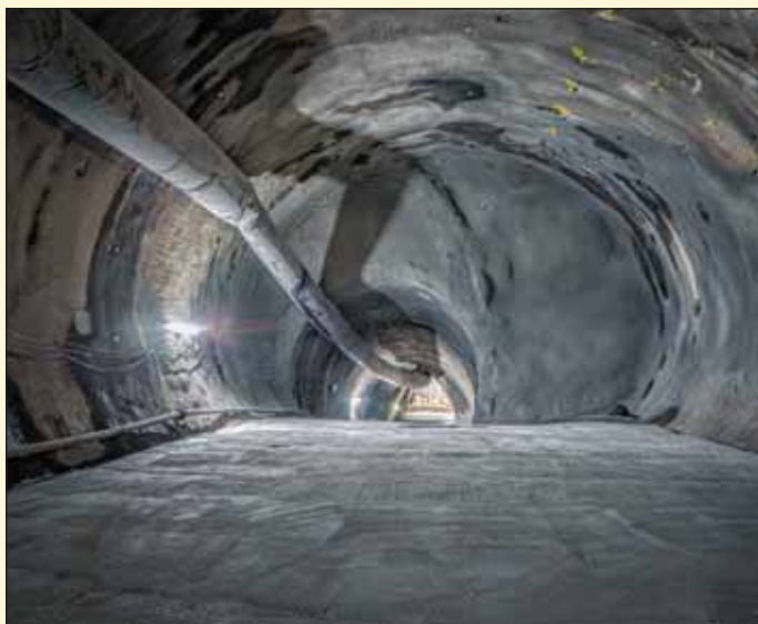
Obr. 2 Stav dokončených ražeb na VO-OL při rozšiřování profilu průzkumné štoly na budoucí tvar dvoukolejného traťového tunelu
