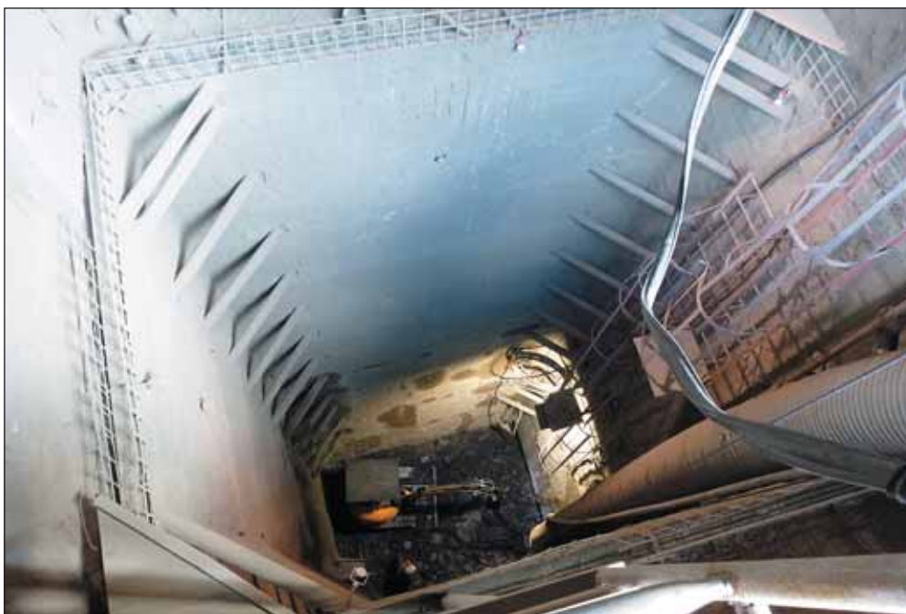
Obr. 2 Hloubení šachty Š2 v obdélníkovém profilu Fig. 2 Excavation of the rectangular profile shaft Š2
