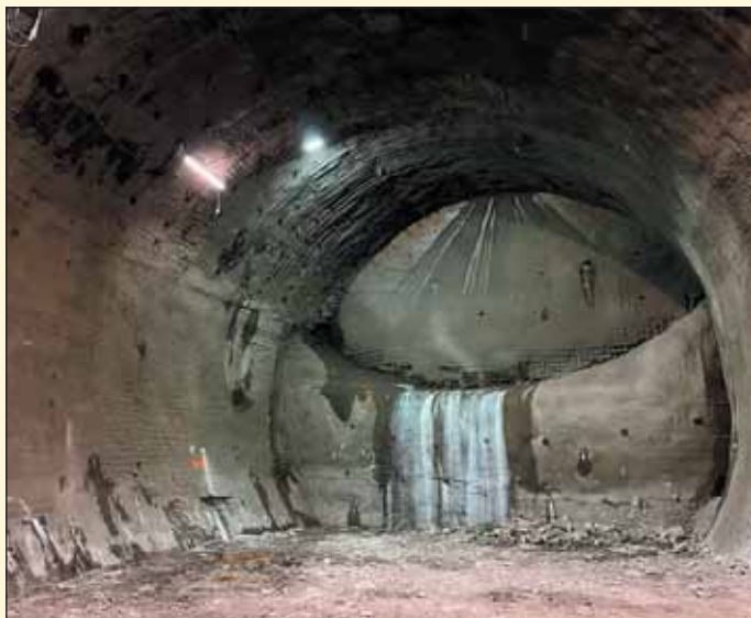
Obr. 1 Stav dokončených ražeb na PAD4 při rozšiřování profilu průzkumné štoly na budoucí tvar přestupní chodby
