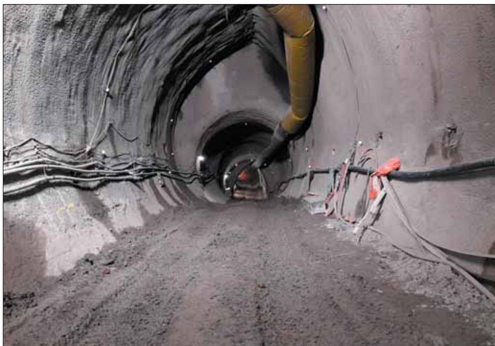
Obr. 6 Pohled na přechodovou část mezi profily o osové vzdálenosti 4,5, přechodovým a patním tunelem Fig. 6 A view of the transition part between profiles with track centre distance of 4.5m, the transition tunnel and bottom drift
