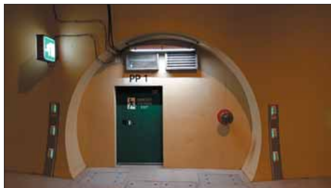
Obr. 2 Núdzový východ do priečného priečného prepojenia Fig. 2 Emergency exit to cross passage passable for persons
