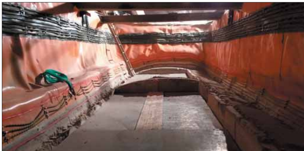
Obr. 6 Napojení hydroizolace v místě průniku do stanice Fig. 6 Connection of waterproofing layers at the penetration into the station
