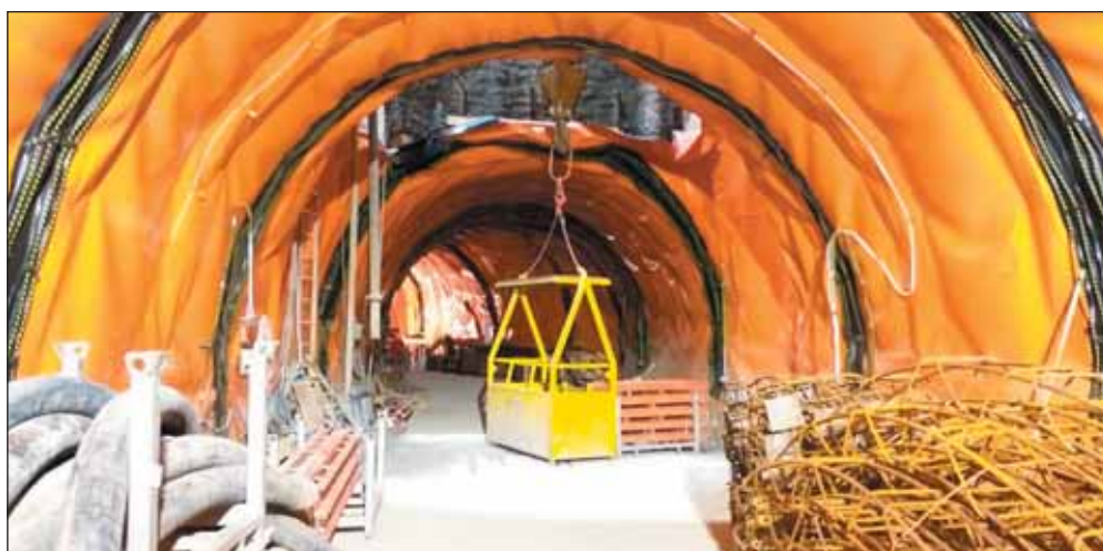
Obr. 7 Průnik těžní šachty Š1 a přestupní chodby Fig. 7 Intersection of hoisting shaft Š1 with transfer corridor
