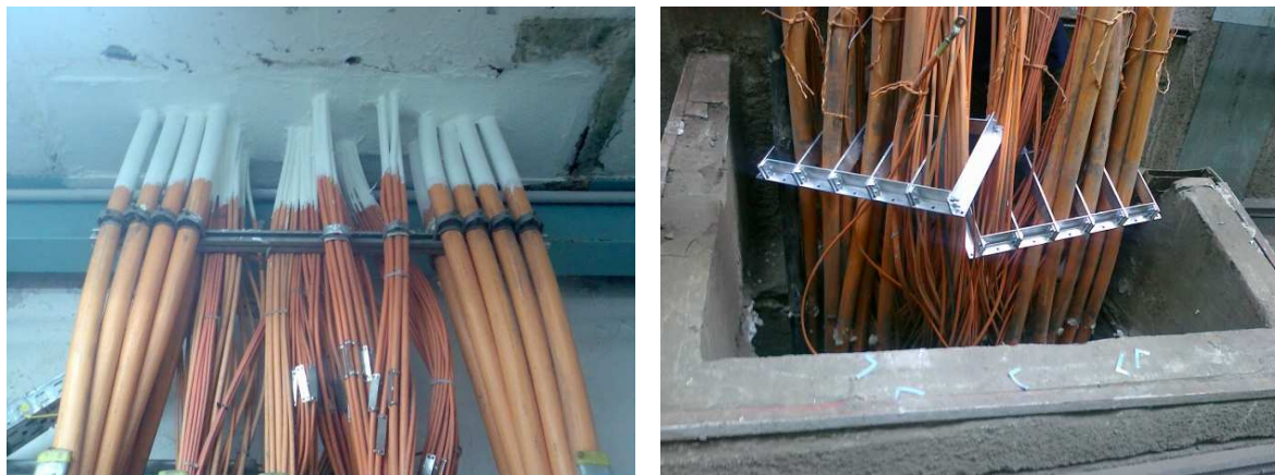
Obr. 2 Pohľad zdola na presiaknuté mäkké upchávky a pohľad zhora na sanáciu prestupu Fig. 2 Bottom view on the soak soft sealing and top view on transit renovation
