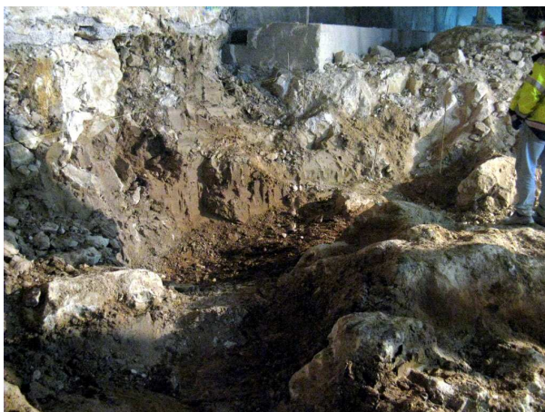
Obr. 9 Kaverna vyplnená ílovitou výplňou v dne tunelovej rúry (280,0 až 290,0 tm) Fig. 9 Cavern filled with clay in the bottom of the tunnel tube (280.0 till 290.0 tunnel m)
