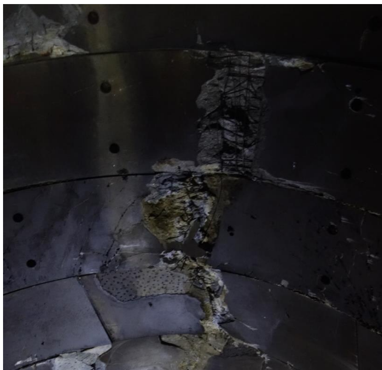
Obr. 5 Nejhůře poškozená část TBM tunelu Fig. 5 Major damages in the TBM section
