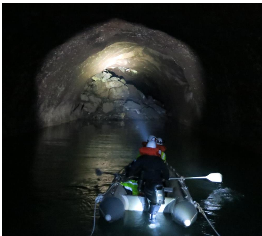
Obr. 2 Inspekce závalu 1 z člunu Fig. 2 The collapse 1 inspection from a boat
