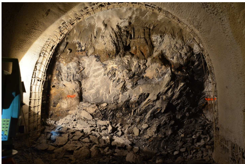
Obr. 8 odhalená pilotová stěna stanice metra (na krajích je dvojice pilot \varnothing 1300 mm - levá pilota zasahuje cca 300 až 350 mm do profilu chodby CH2 a uprostřed je trojice pat pilot \varnothing 900 mm, které původně nebyly dohloubeny až na dno původní stavební jámy) Figure 8 Fixing of the supporting frames of the piles made of steel weldment.
